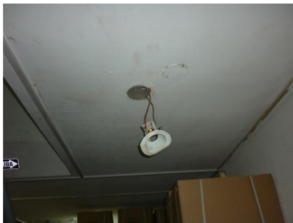
Figura 4.1.4 de la iluminación en las bodegas
