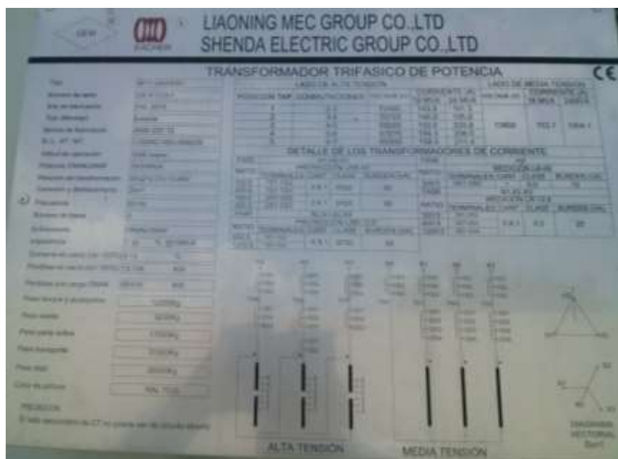
Figura 1.2: Placa del Transformador de Potencia de S/E Daule Norte.
