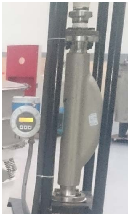
Figura 2.6: Indicador de la cantidad de licor enviado hacia almacenamiento.
