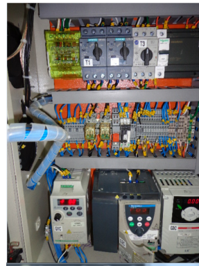
Figura 4.3: Panel de fuerza accionamiento de las bombas y centro de carga de 220V.
