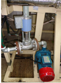
Figura 4.5: Bomba y válvula reguladora de flujo a través de la torre de enfriamiento.
