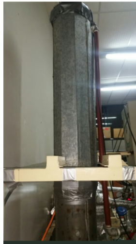
Figura 4.7: Torre de enfriamiento, ventilador y tanque de agua a enfriar.
