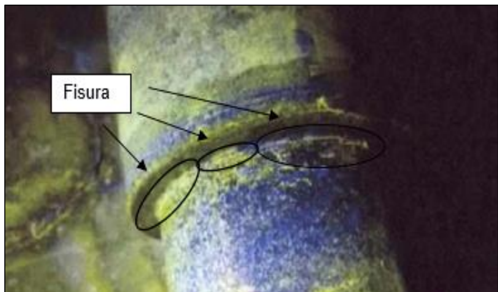
Figura 2.38 Ensayo de Partículas Magnéticas en el Eje Antes de Fallar.
