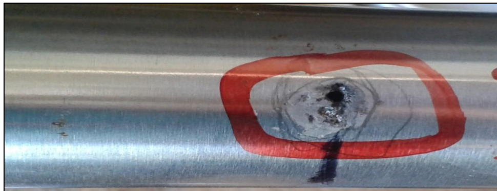
Figura 4.3 Tubería Horizontal con Picadura Tramo 3
