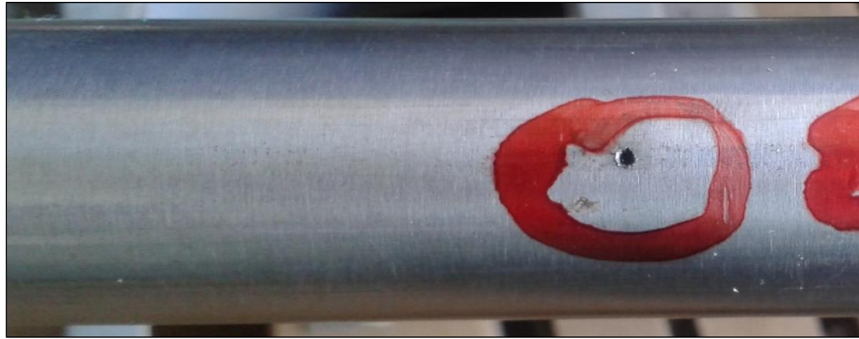
Figura 4.1 Tubería Horizontal con Picadura Tramo 1
