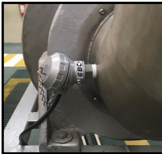
Figura 3.21: Soporte de sensor de temperatura de salida.
