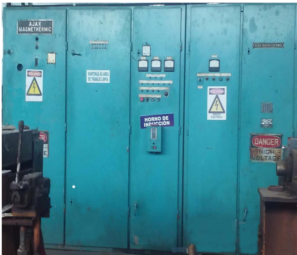
Figura 1.3: Vista frontal del panel de la Fuente de Poder del Horno
