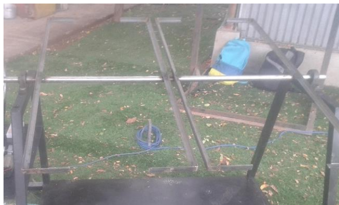
Figura 3.10: Soporte de los Paneles Fotovoltaicos.
