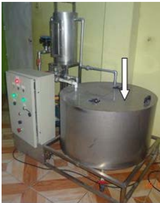
FIGURA 3.3. Tanque de almacenamiento de agua
