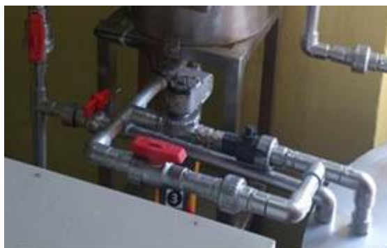
FIGURA 3.6. Válvulas de operación manual
