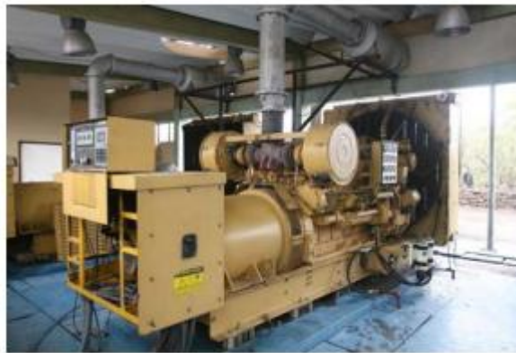
Figura 2.5: Foto del generador térmico a diésel Caterpillar-3512 [4]
