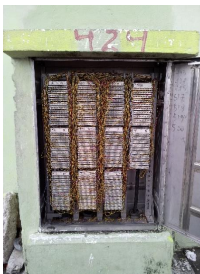
Figura 2.4: Armario de Distribución.
