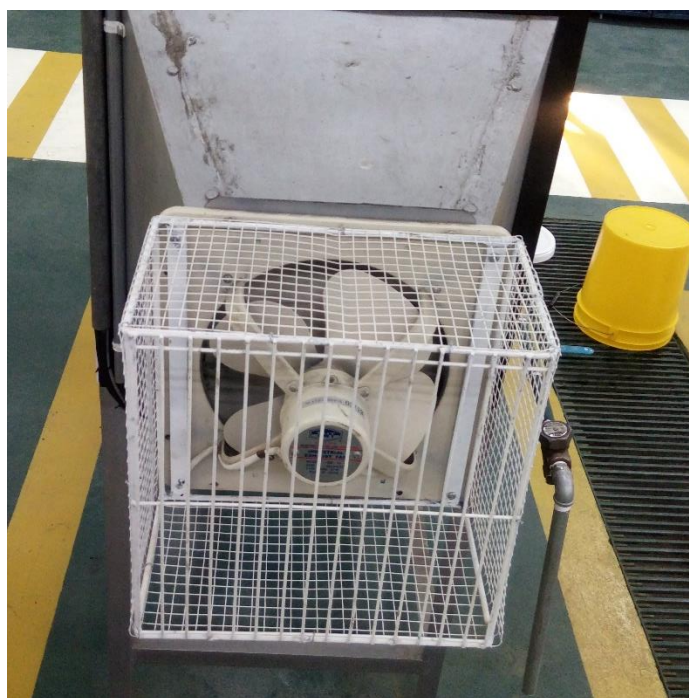
Protección del Ventilador.
