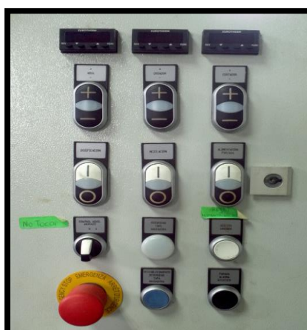
Figura 3.11: Panel de control para operador [18]
