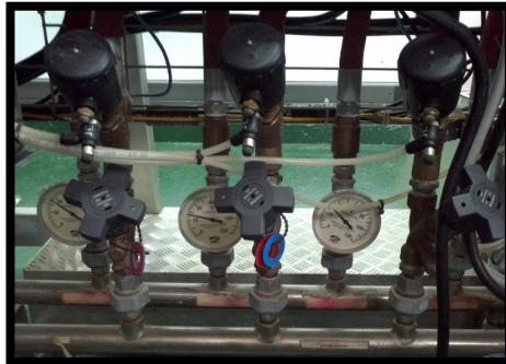
Figura 4.9: Válvulas neumáticas y manómetros de presión [18]
