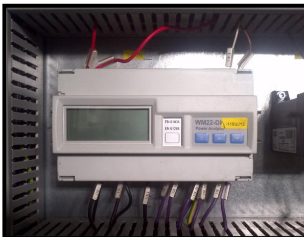
Figura 4.1: Analizador de redes Modelo WM22-DIN estado apagado [18]
