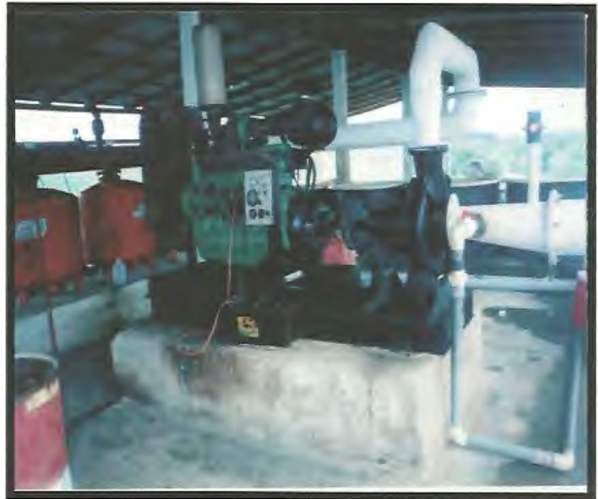
Foto. 5.- Estación de riego.
