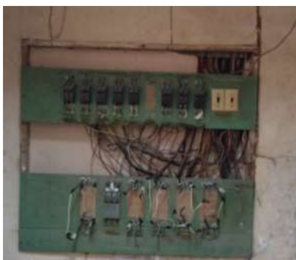
Figura #2 Panel de Disyuntores PB-AD
