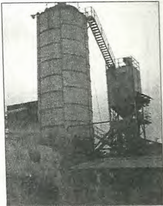
FOTO No. 11 ALIMENTACION DE CEMENTO Y DOSIFICACION. SILOS DE ALIMENTACION Y CONSUMO
