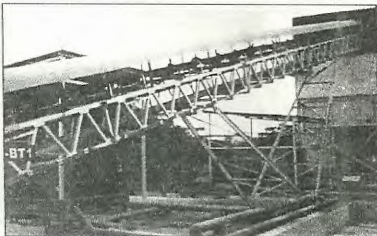
FOTO No. 7.- BANDA TRANSPORTADORA Y TOLVA DE DOSIFICACION
