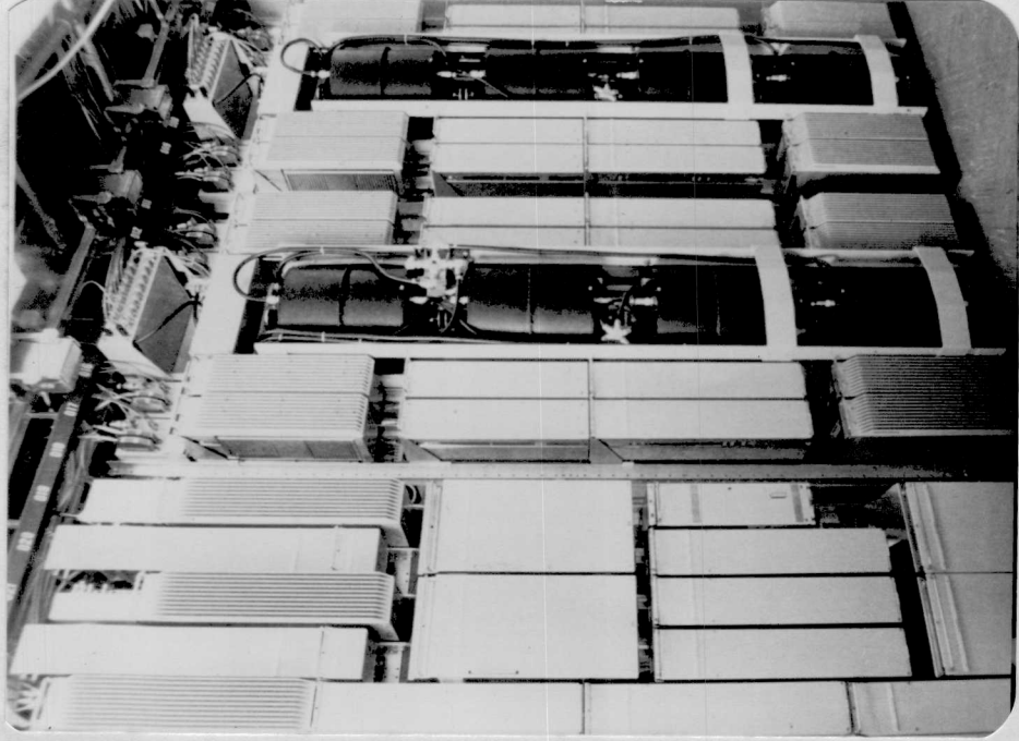
FIGURA 27.- CONFIGURACION DEL EQUIPO DE UNA ESTACION BASE.
