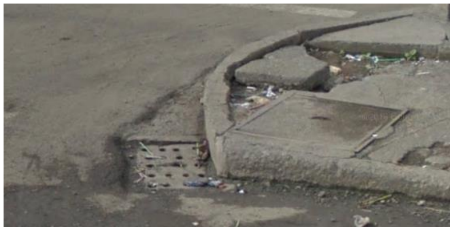
Fig. 3.13. Avistamiento de los puntos de drenaje en la intersección de las calles 24 de Mayo y Manabí. Se observan tapas de hormigón armado y la tapa de su respectiva caja de revisión.
