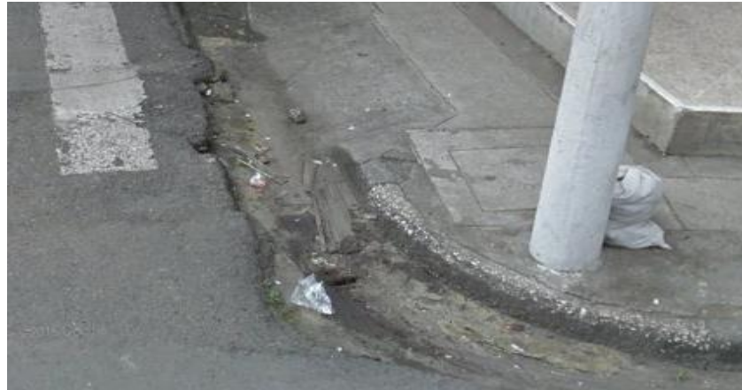
Fig. 3.6. Sumidero pluvial (metálico) ubicado en la intersección de las calles 24 de Mayo y Pedro Carbo.
