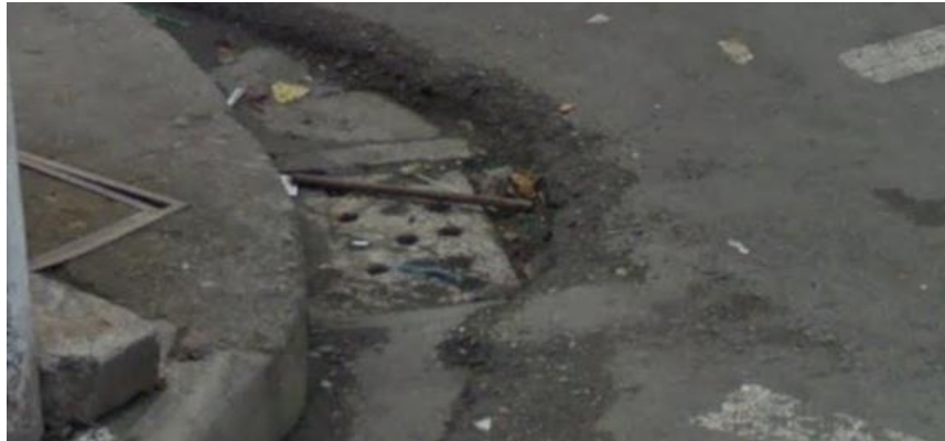
Fig. 3.12. Presencia de puntos de drenaje compuestos por tapas de hormigón con aberturas circulares y caja de revisión en la intersección de las calles 24 de Mayo y Miguel Valverde.
