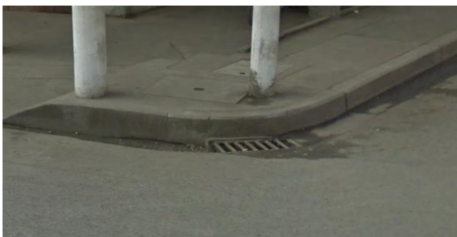
Fig. 3.8. Visualización de punto de drenaje pluvial (metálico) y canaletas de direccionamiento de aguas pluviales en la intersección de las calles 24 de Mayo y 9 de Octubre.
