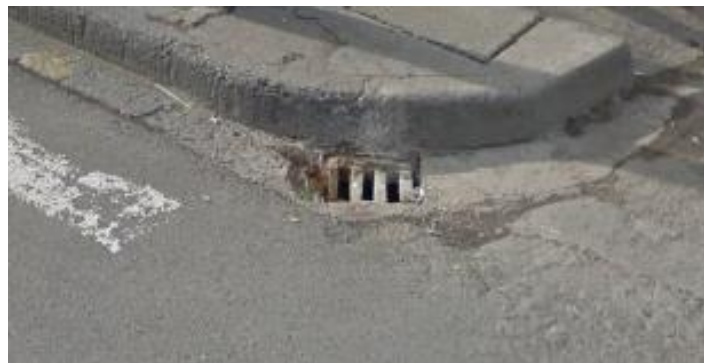
Fig. 3.11. Visualización de punto de drenaje pluvial (hormigón) y canaletas de direccionamiento de aguas pluviales en la intersección de las calles 24 de Mayo y 12 de Febrero.
