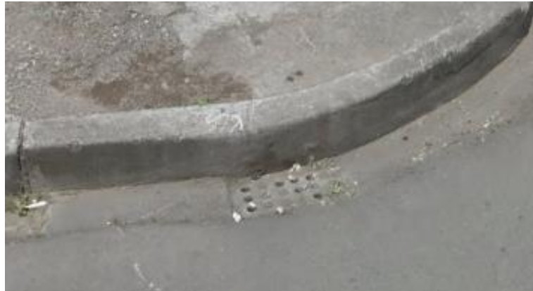
Fig. 3.16. Presencia puntos de drenaje en la intersección de las calles 24 de Mayo y S/N. Dichos puntos posee una tapa de hormigón y sus respectivas canaletas de drenaje.
