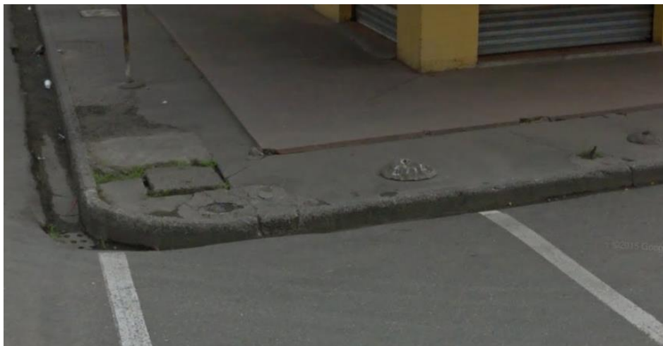
Figura 3.2. Sumidero pluvial ubicado en la intersección de las calles 24 de Mayo y Los Chirijos.
