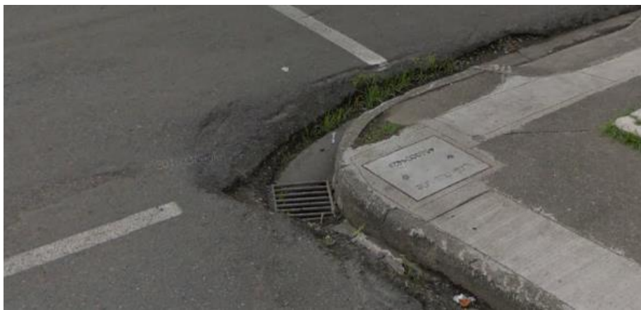
Figura 3.03. Sumidero pluvial ubicado en la intersección de las calles 24 de Mayo. Fuente: Tomada por el autor
