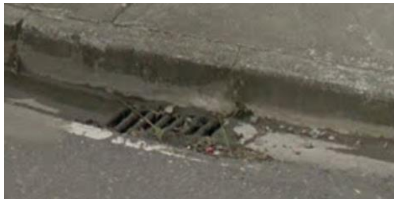
Fig. 3.18.- Visualización de punto de drenaje en la intersección de las calles 24 de Mayo y av. Amazonas. Dicho punto posee canaletas de direccionamiento de aguas pluviales.
