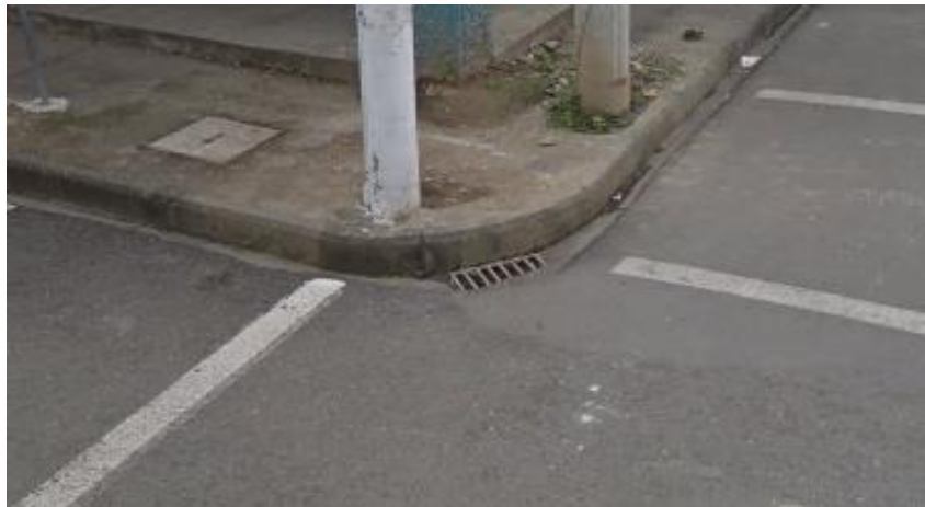
Fig. 3.5 Sumidero pluvial (metálico) ubicado en la intersección de las calles 24 de Mayo y Simón Bolívar.
