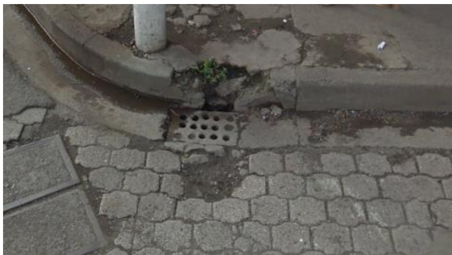
Fig. 3.14. Avistamiento de los puntos de drenaje en la intersección de las calles 24 de Mayo y Gral. Eloy Alfaro. Se observan tapas de hormigón armado y la tapa de su respectiva caja de revisión.
