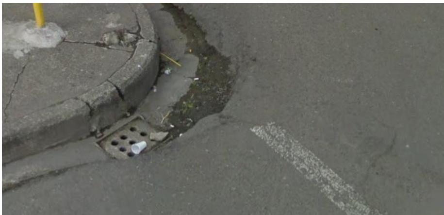
Fig. 3.4. Sumidero pluvial (hormigón) ubicado en la intersección de las calles 24 de Mayo y Ernesto Seminario. Fuente: Tomada por el autor
