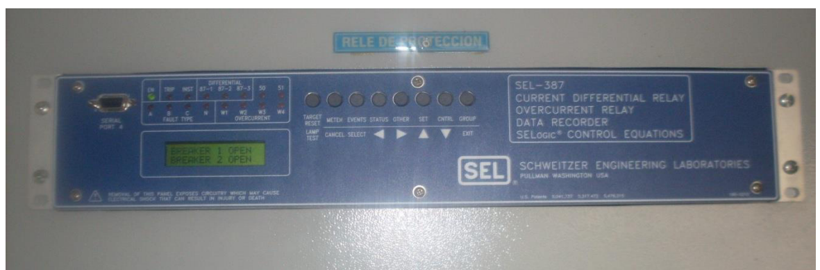
Figura 1.17 Relé de Protección Diferencial SEL-387
