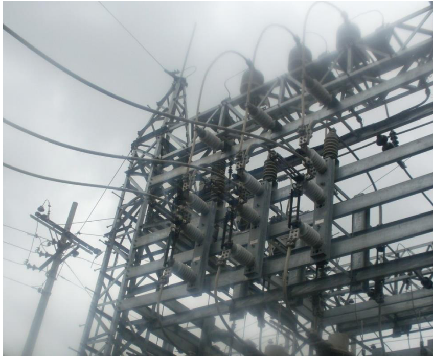
Figura 1.10 Seccionador Monopolar a 13.8 KV
