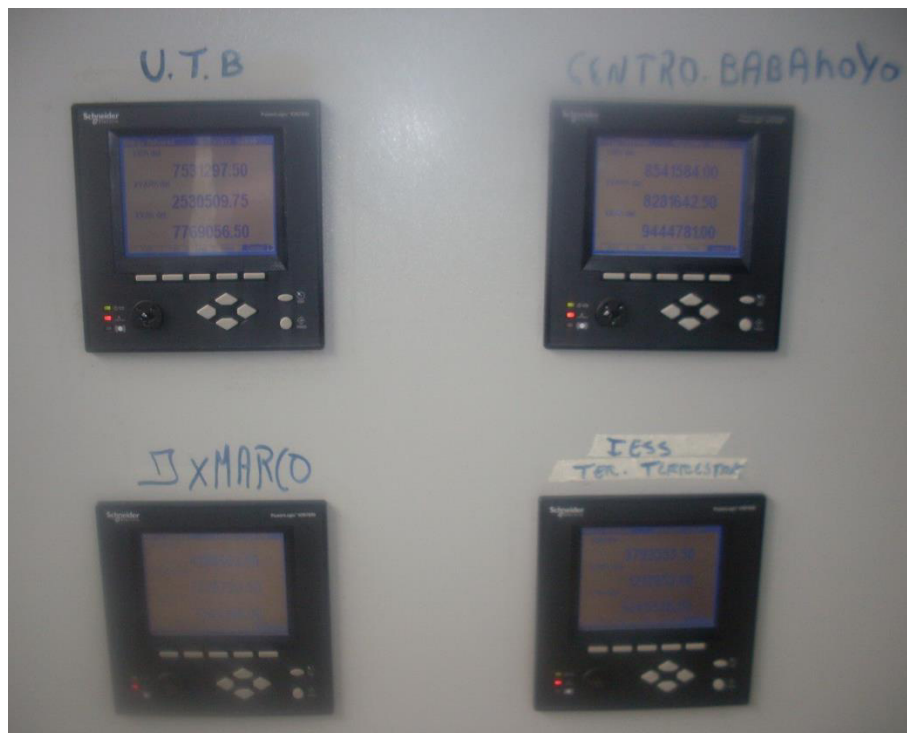
Figura 1.16 Medidores de las 4 alimentadoras de la subestación
