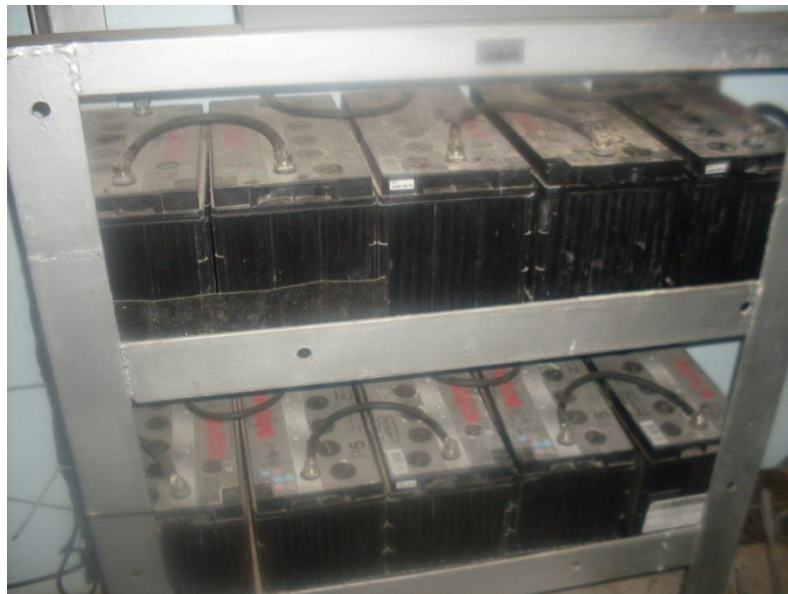
Figura 1.19 Banco de Batería
