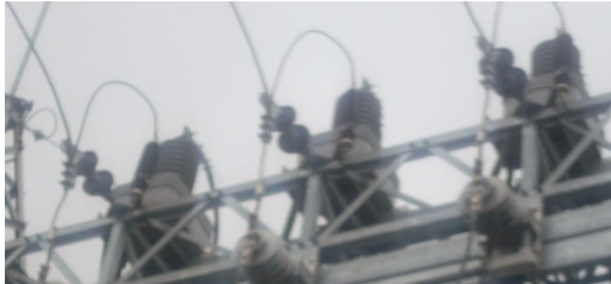
Figura 1.13 Transformadores de Potencial del Patio de 13.8 KV
