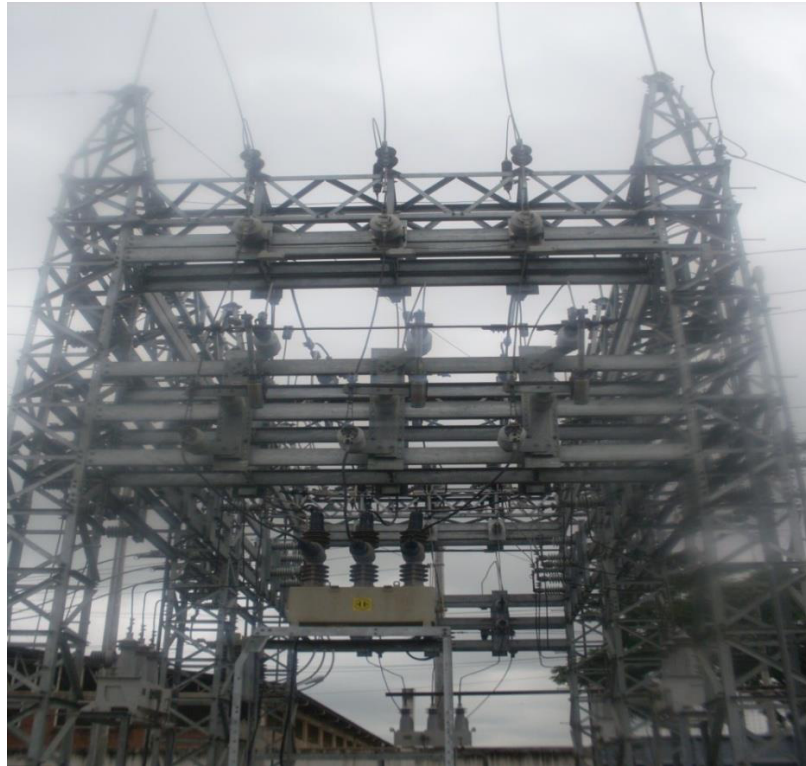
Figura 1.9 Patio de 13.8 KV
