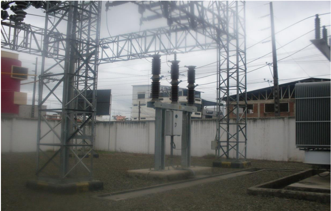
Figura 1.3 Patio de 69KV
