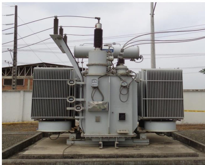
Figura 1.7 Transformador de potencia -Terminal Terrestre
