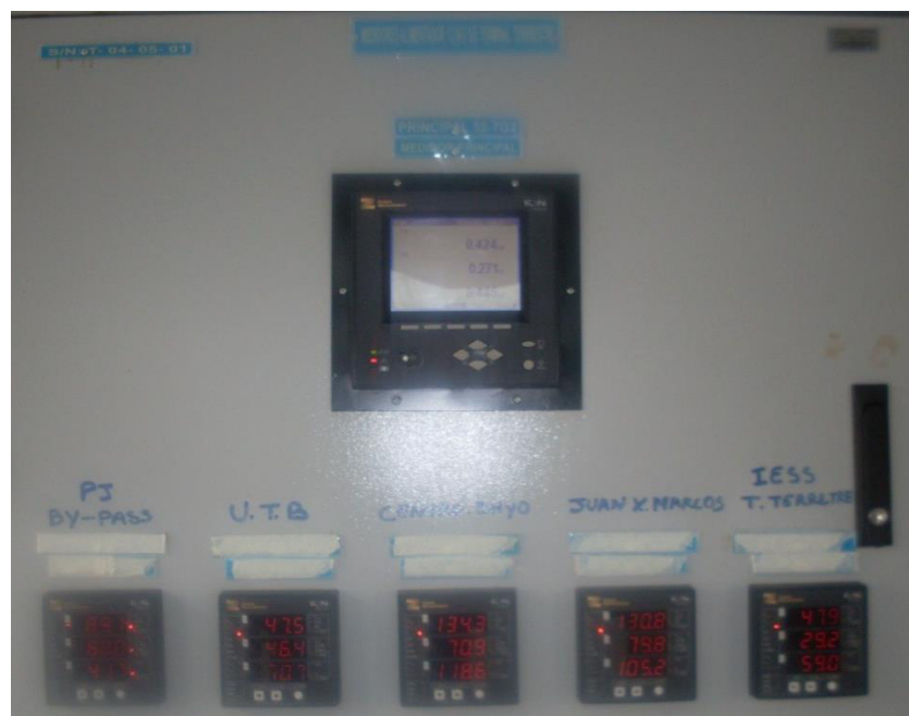
Figura 1.15 Medidor polifuncional de la subestación Terminal Terrestre
