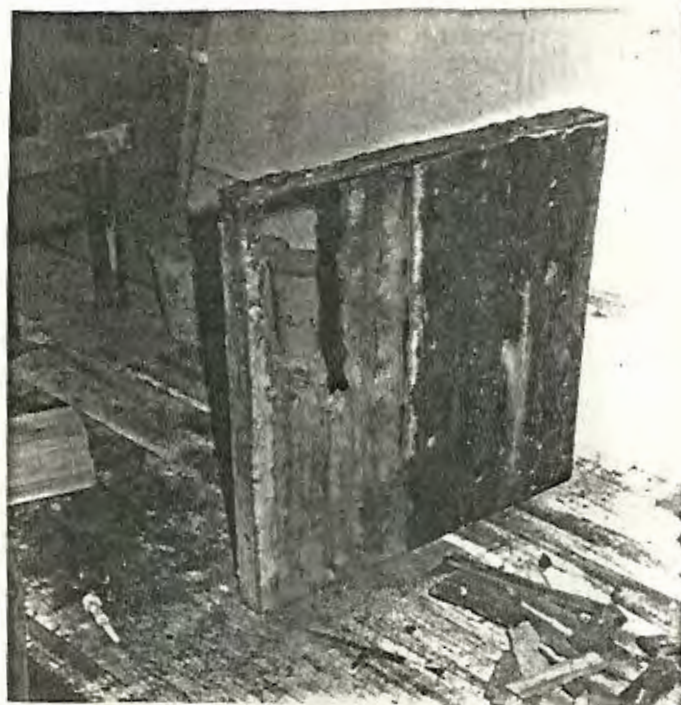
FIG. 66.- INTERIOR DEL PANEL DESPUES DE PRUEBA AL FUEGO.
