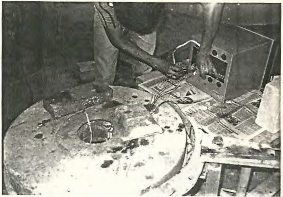
FIG. 54.- CONECTADO DE TERMOCUPLAS
