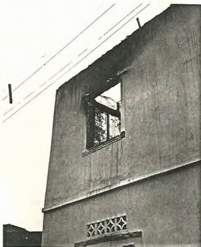
FIG. 67.- EDIFICACION ATACADA POR EL FUEGO
