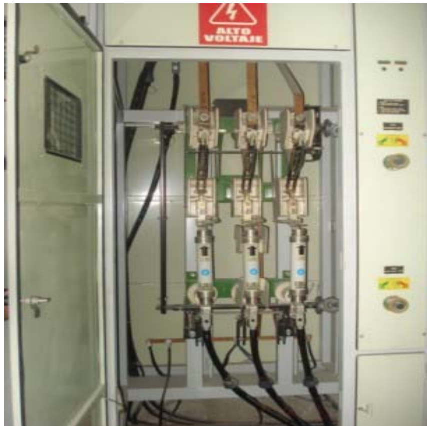
Celda # 16. En su interior se muestra los Fusible INEPAR de 40 A.
