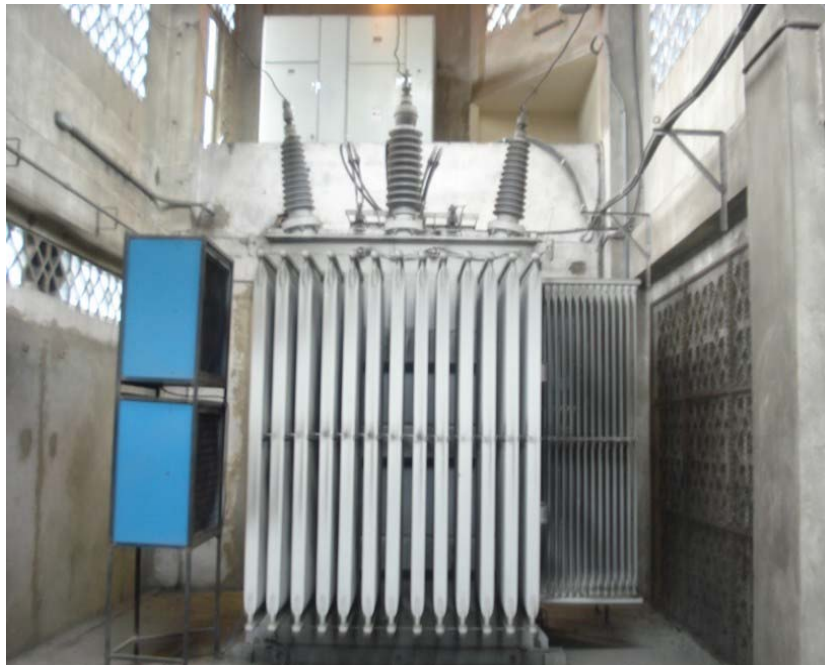
TR0: Transformador Principal 69/13,2KV
