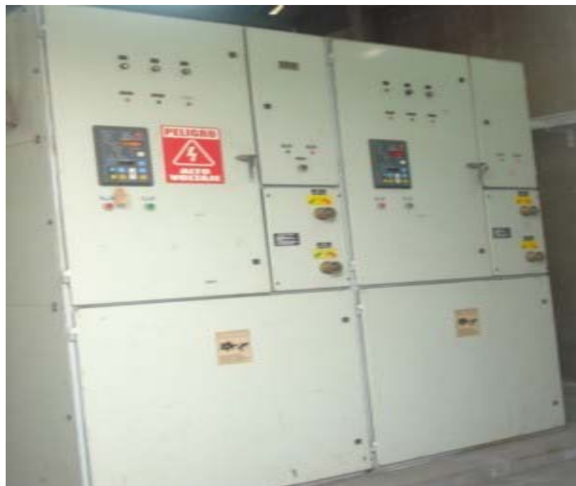
Celda # 4 y 5. Dentro de ellas se encuentra la barra Principal de 13,2 KV
