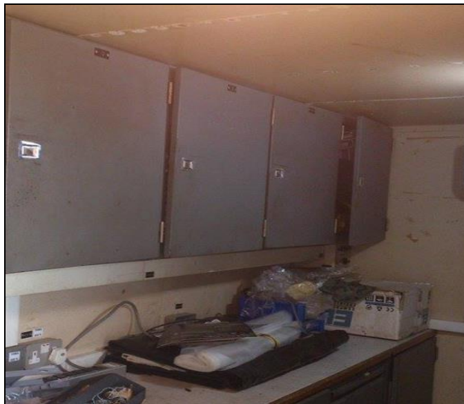
Figura 3.14 Vista Interna del Laboratorio para Tableros del Controlador e Inversor- FAE
