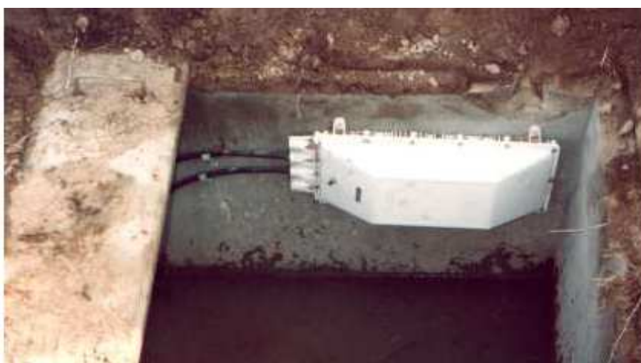
Fig. 4-8.- Caja de empalme situada en arqueta
