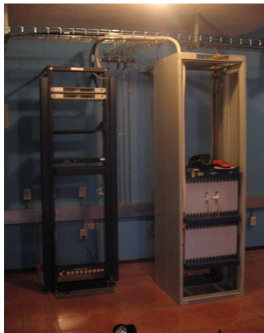
Fig. 4.1.- Instalación de de Rack y Gabinetes
