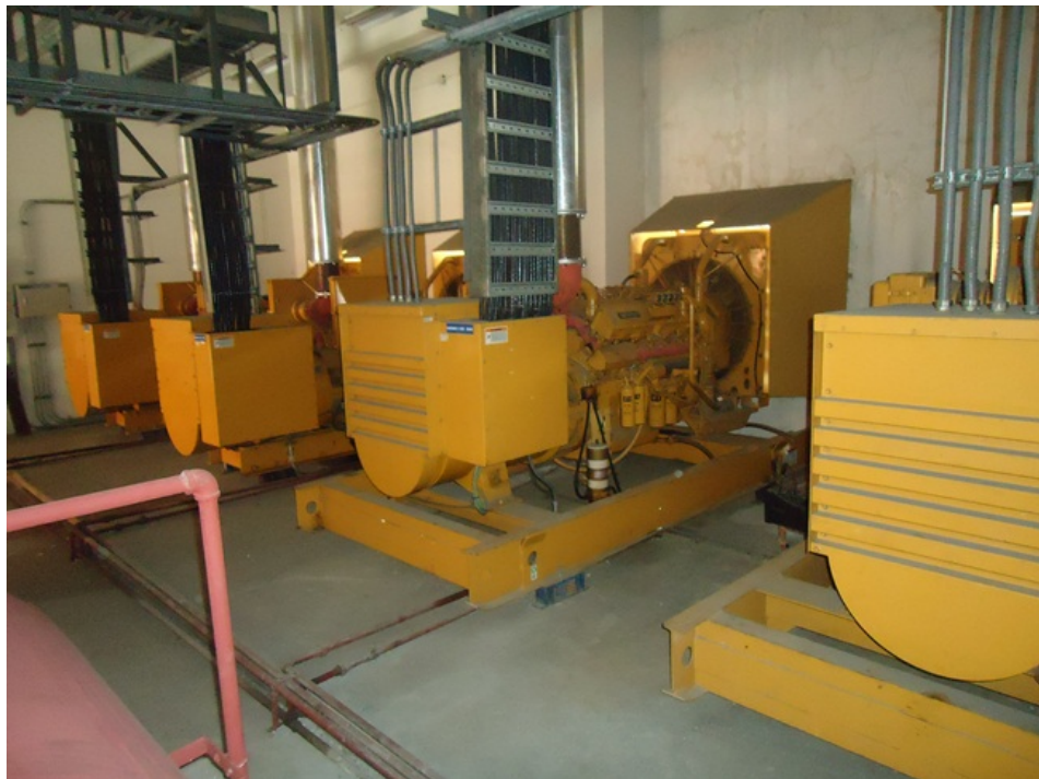
Figura 1.2 Cuarto de Generadores del Hospital “Roberto Gilbert Elizalde”
