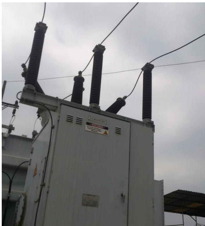
Figura 1.13 Pararrayos sobre el transformador de potencia
