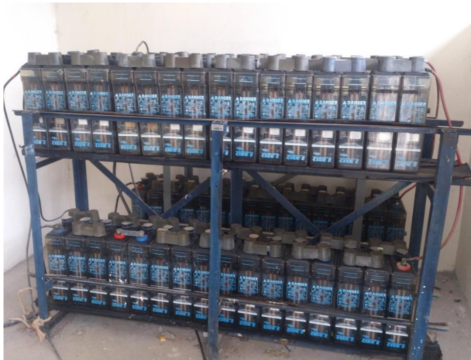
Figura 1.14 Banco de baterías de 1,75 VDC c/u.
