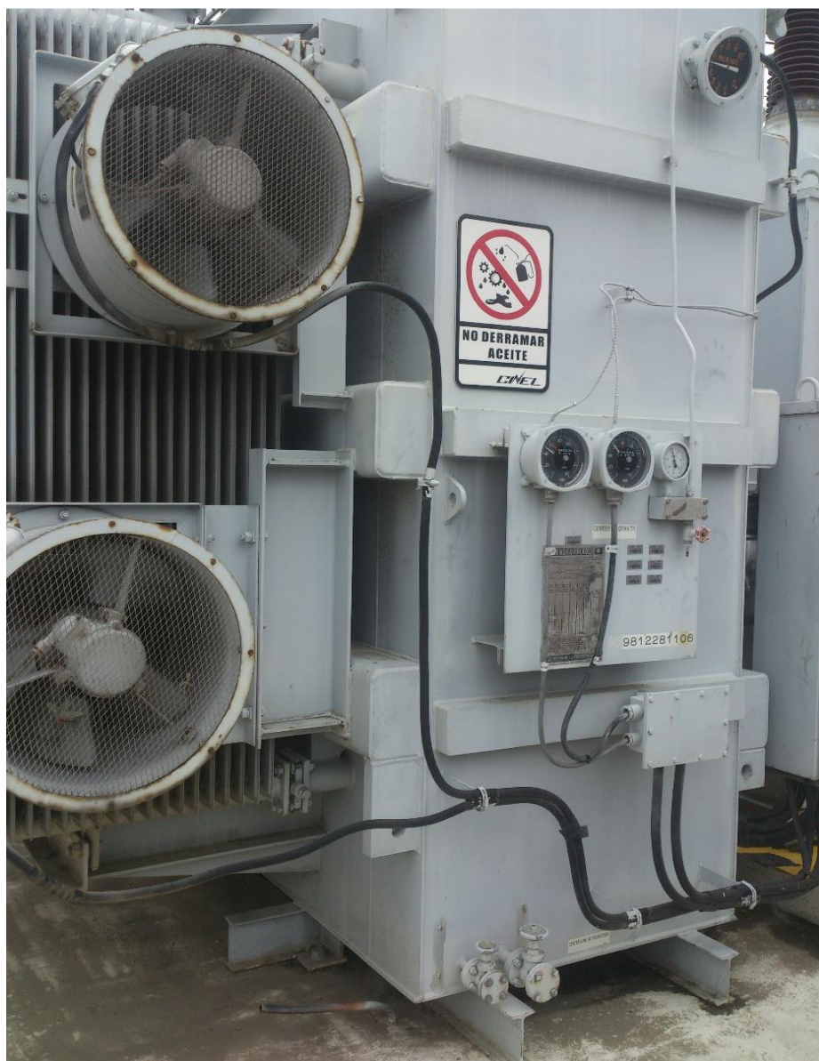
Figura 1.12 Transformador de potencia
