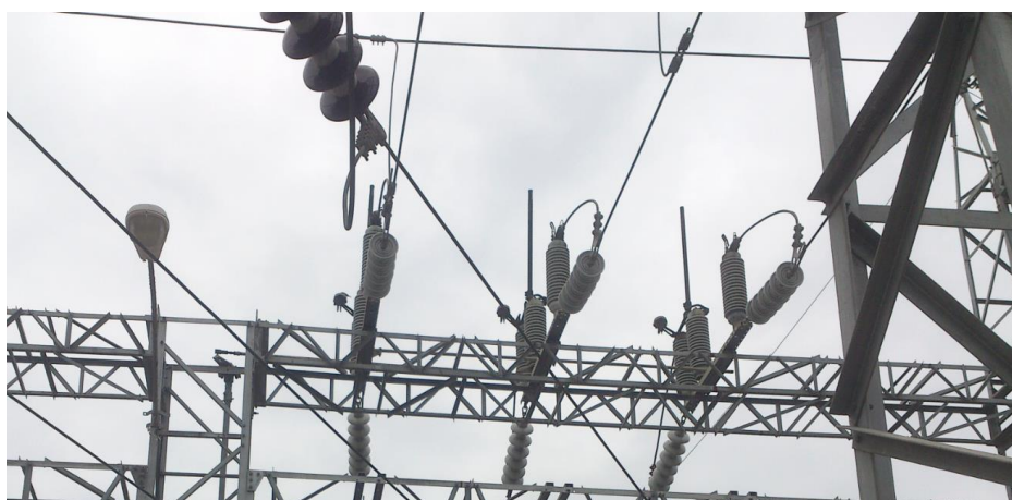
Figura 1.7 Seccionador de aire 69 kV.
