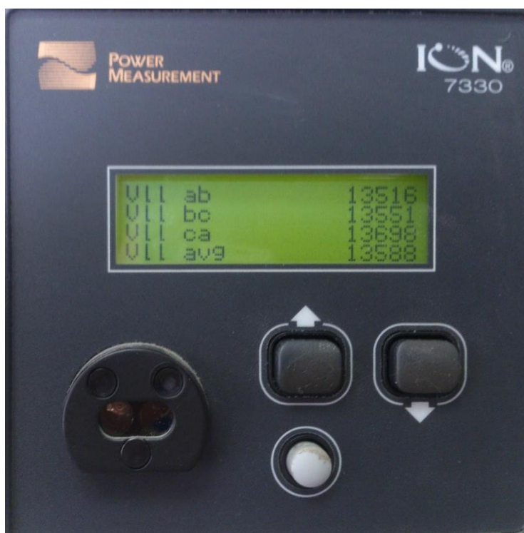
Figura 1.16 Medidor en la S/E Milagro Sur.
