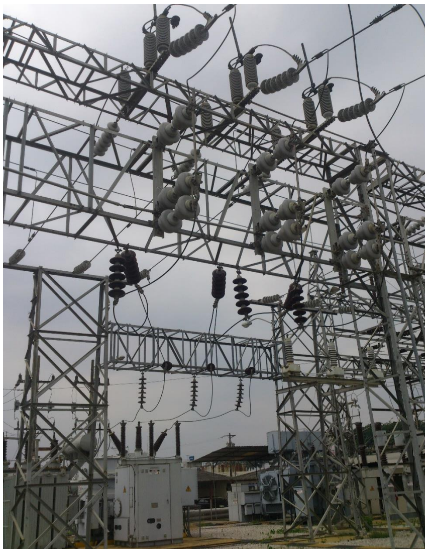
Figura 1.5 Estructura en el lado de alta tensión
