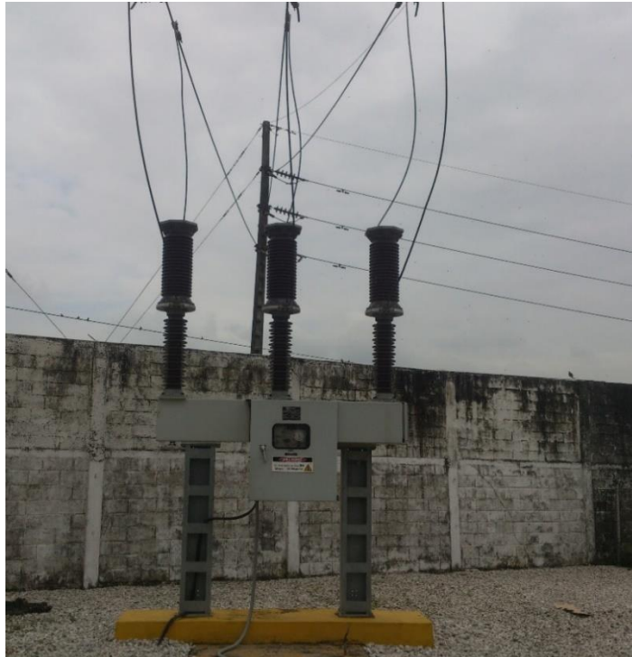
Figura 1.8 Interruptor en gas SF6
