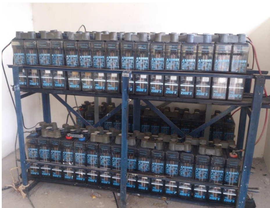
Figura 1.14 Banco de baterías de 1,75 VDC c/u.
