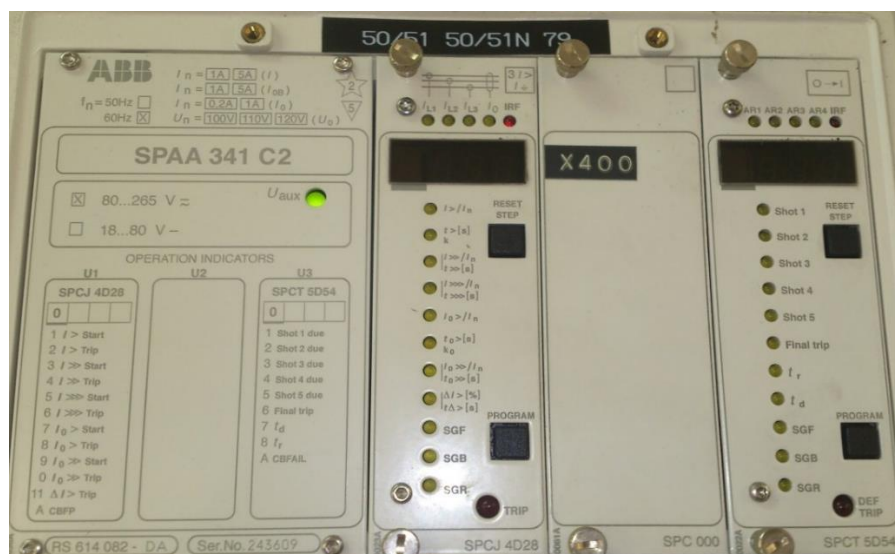
Figura 4.11 Relé SPAA 341 C2 para protección de las alimentadoras El módulo SPCJ 4D28 es el encargado de la protección contra sobrecorrientes/cortocircuito y contra fallas a tierra. El módulo SPCT 5D54 tiene la función de recierre.
