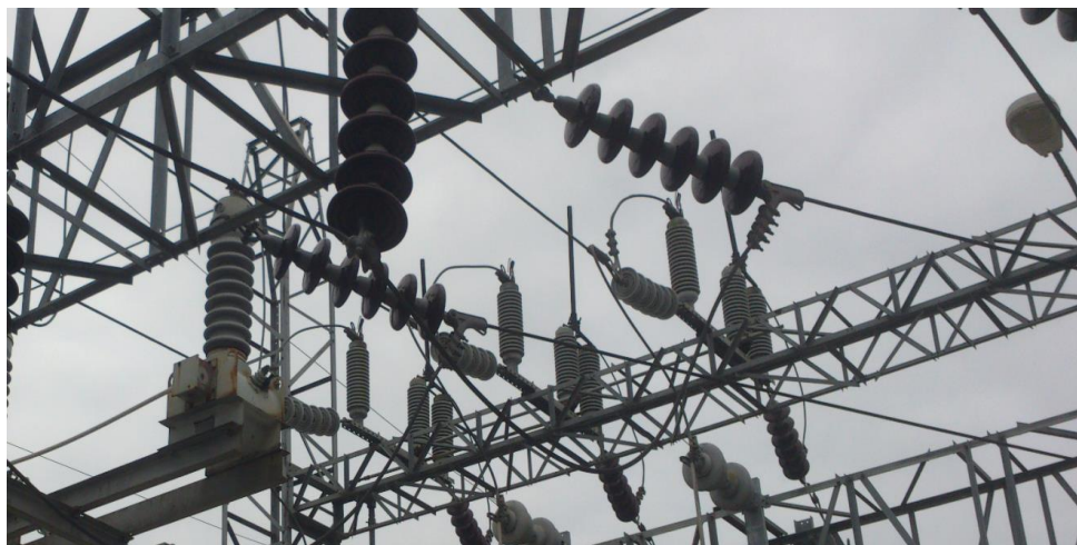
Figura 1.11 Pararrayos en el lado 69 Kv
