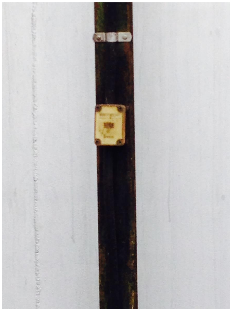
Figura 11. Contador de descargas (ubicado en tanques de producción intermedia)
