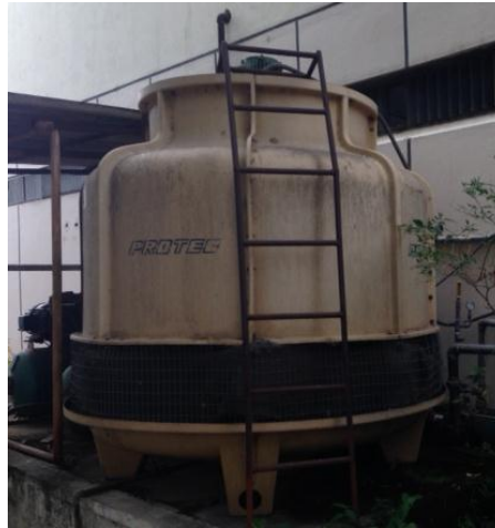
FIGURA 1.8 Torre de enfriamiento
