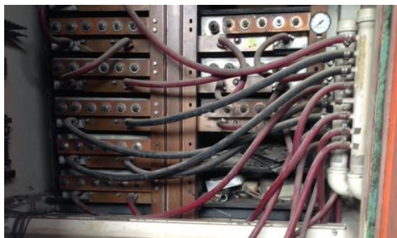
FIGURA 1.3 Banco de capacitores del horno
