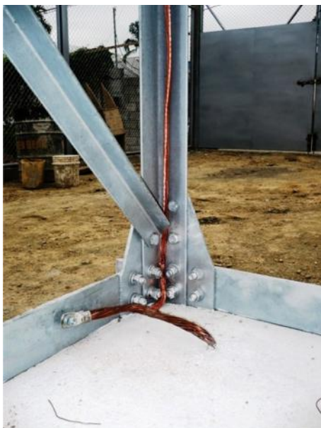
Figura 8. Puesta a tierra de estructuras metálicas
