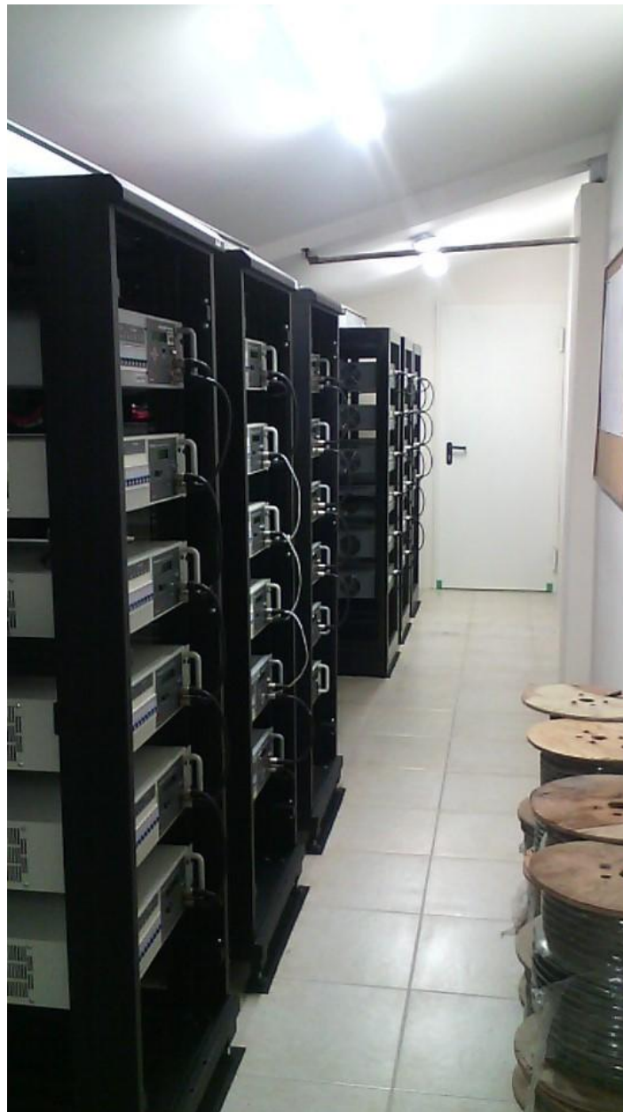
Figura 2.2: Cuarto de dimmer
