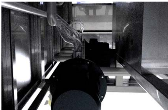
Figura 3.5. Detalle del sistema de bombeo
