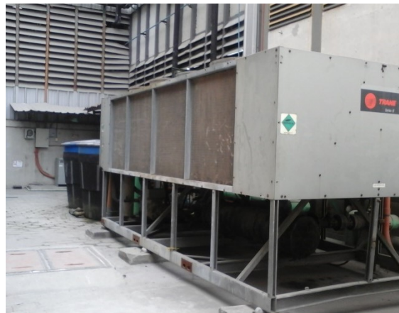
Fig. 4.2: Chiller y tanques cónicos de 1000l.
