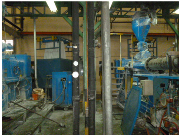
Fig. 4.5: Red de agua helada, llegada y retorno de línea de producción XT-11.
