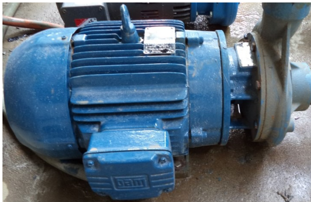
Fig. 3.3: Bomba para la red de agua del chiller de 80 toneladas de refrigeración.
