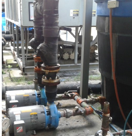
Fig. 4.1: Estación de bombeo.
