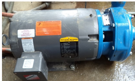
Fig. 2.3: Bomba para la red de agua helada.
