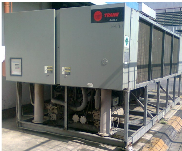
Fig. 3.2: Chiller de 80 toneladas de refrigeración.
