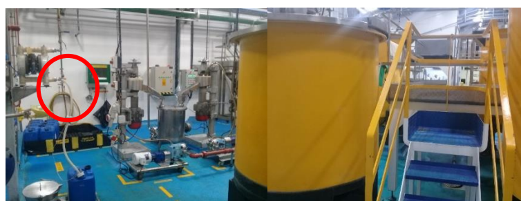
Figura 2.14 Puntos de limpieza. Causa Raíz No. 6
