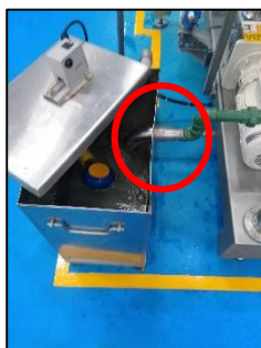
Figura 2.13 Bombas de vacío. Causa Raíz No. 1
