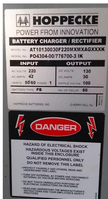
Figura 1. 18: Placa del cargador de baterías
