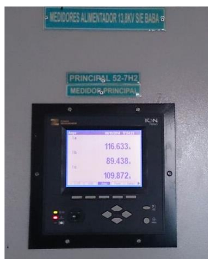
Figura 1. 19: Medidor de calidad de energía ION7650
