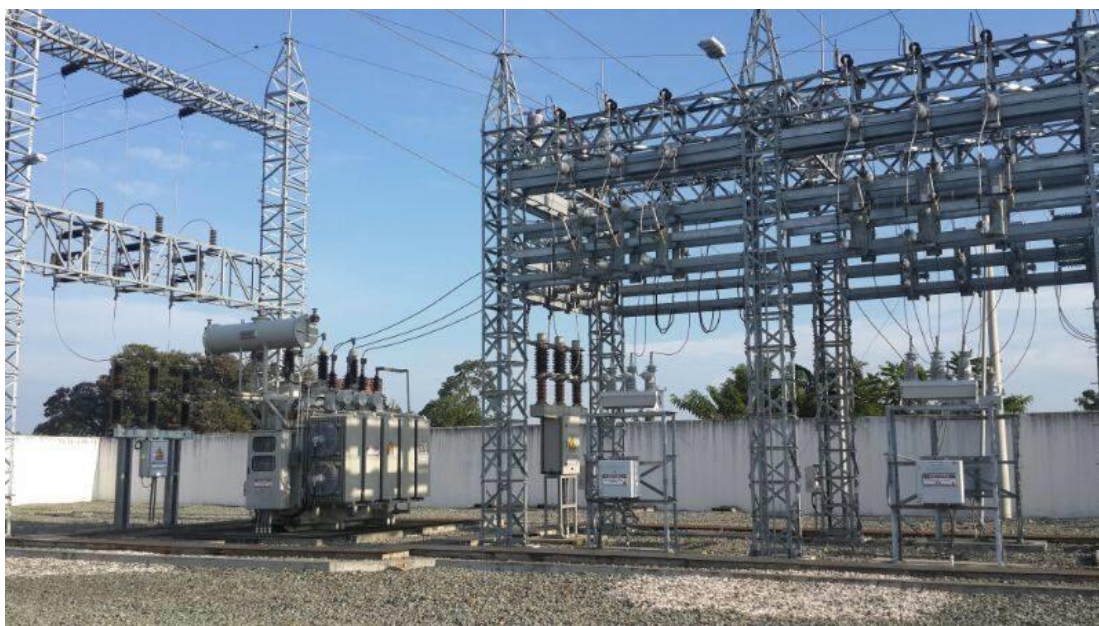
Figura 1. 2: Vista interior de la Subestación Baba
