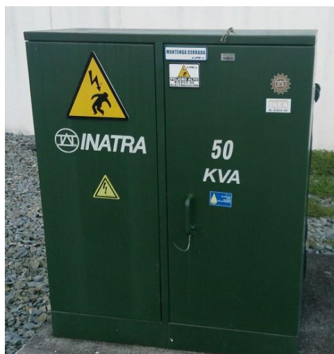
Figura 1. 14: Transformador trifásico Padmounted
