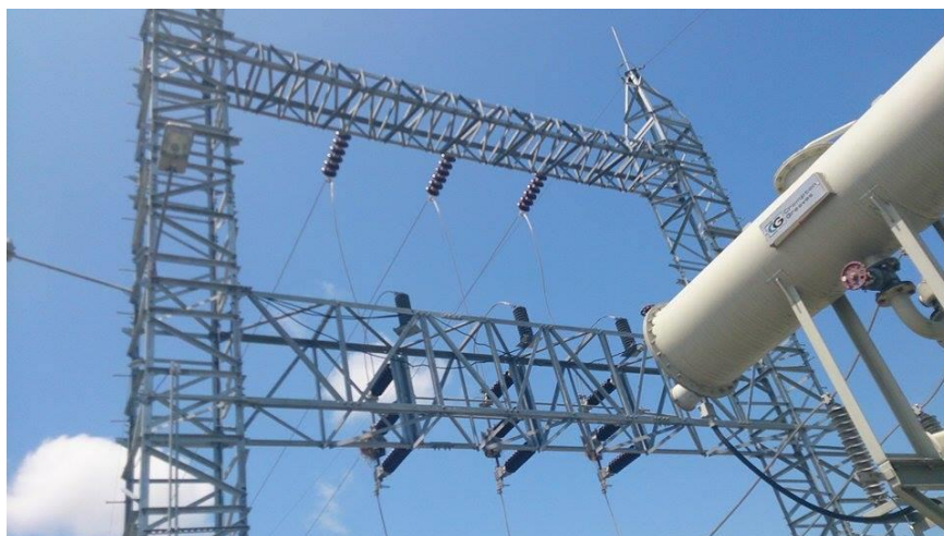
Figura 1. 6: Vista de la estructura de 69 KV
