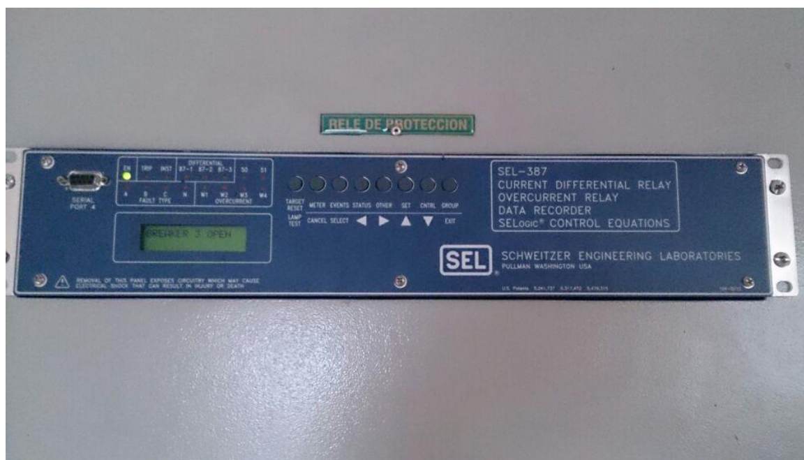
Figura 1. 21: Panel frontal del relé SEL 387
