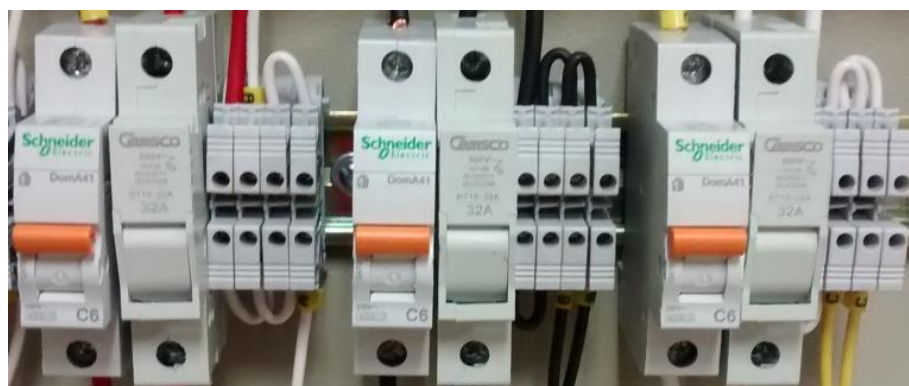
Fig. 3.14. Breakers y fusibles para fases.
