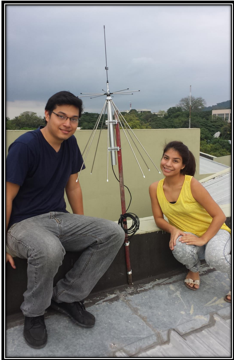
Instalación de la Antena Omnidireccional en el Edificio Principal de la FIEC
