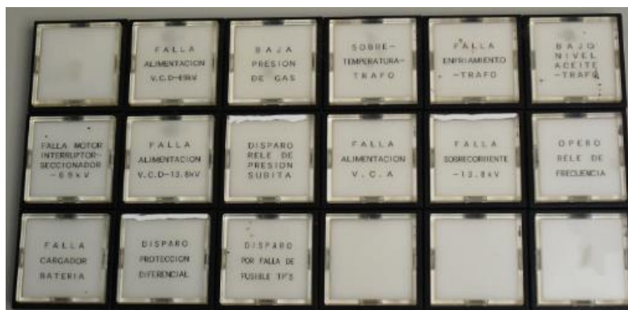
Figura 1.15 Panel de alarmas
