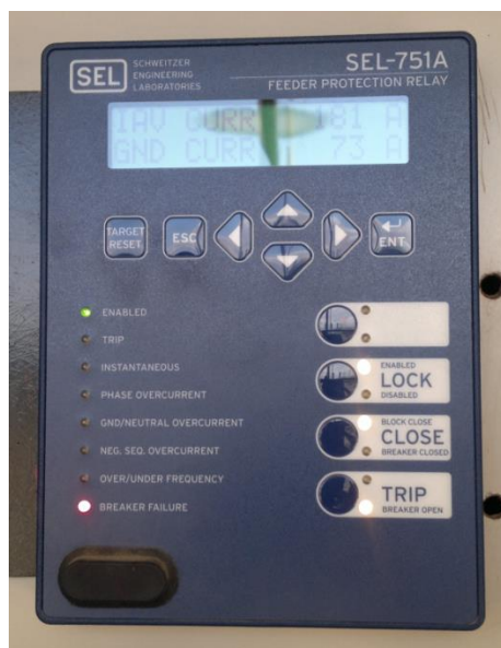
Figura 1.12 Relé de protección de alimentador SEL-751A
