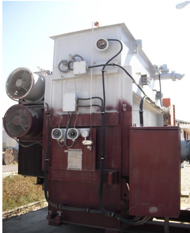
Figura 1.5 Transformador de potencia MITSUBISHI
