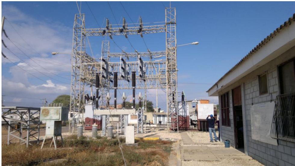
Figura 1.2 Vista total de la Subestación Playas
