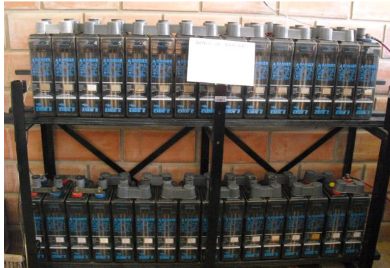
Figura 1.8 Banco de baterías
