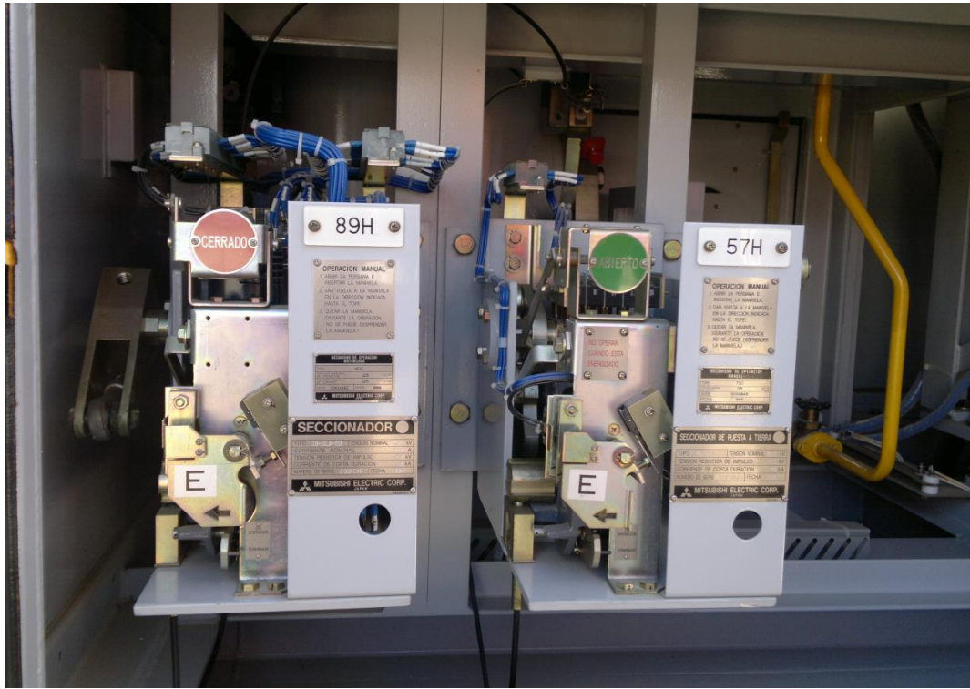
Figura 1.4 Seccionador tipo 70 – GLA-20 marca MITSUBISHI
