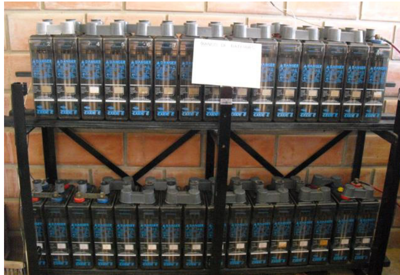
Figura 1.8 Banco de baterías
