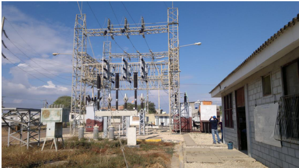
Figura 1.2 Vista total de la Subestación Playas
