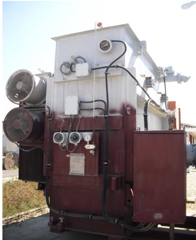
Figura 1.5 Transformador de potencia MITSUBISHI
