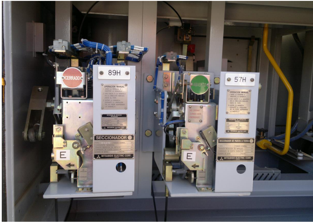
Figura 1.4 Seccionador tipo 70 – GLA-20 marca MITSUBISHI
