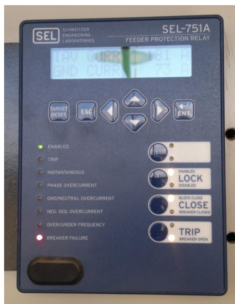
Figura 1.12 Relé de protección de alimentador SEL-751A
