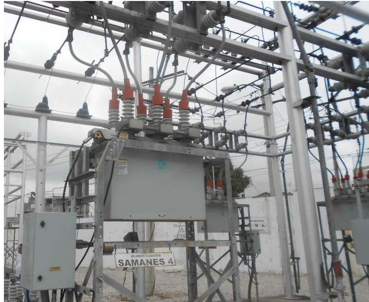
Figura 1.5: Estructura de Seccionadores Alimentadora Samanes 4.
