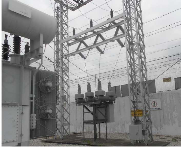
Figura 1.3: Estructura de 69kv y Disyuntor.
