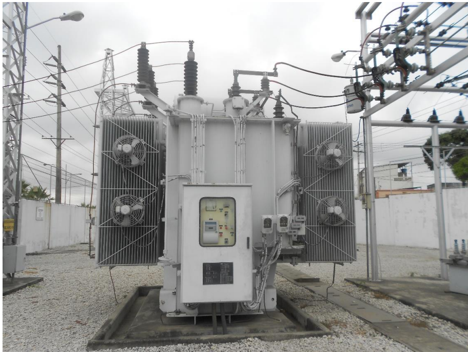
Figura 1.4: Transformador de potencia
