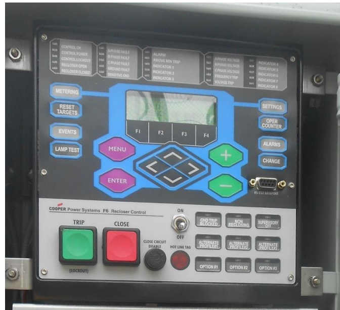
Figura 1.6: Panel de control del Reconectador de cada alimentadora.
