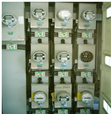
FIGURA 4.5. RED LAN MEDIDORES
