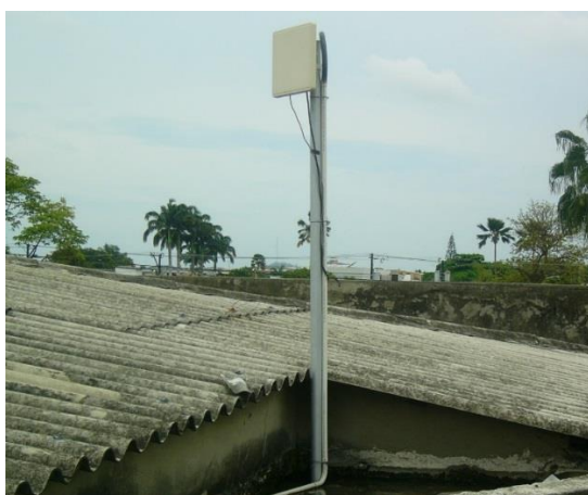
FIGURA 4.6. ANTENA WLL ECUTEL INSTALADA Elaborado por: Eddie Calderón M., 2005
