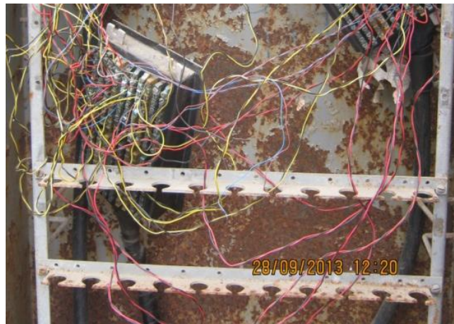
Figura 3.22 Regleta Primaria en Armario 01 (Regletas 4 y 5)
