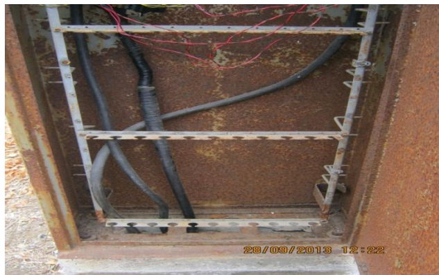
Figura 4.3 Armario 02 sin conexión a tierra
