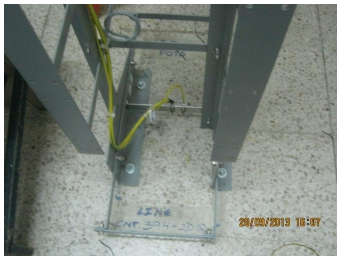
Figura 3.18 Conexión a Tierra de MDF en Central Lago Capeira
