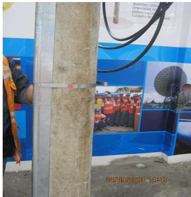
Figura 3.27 Cableado Aéreo (Poste)
