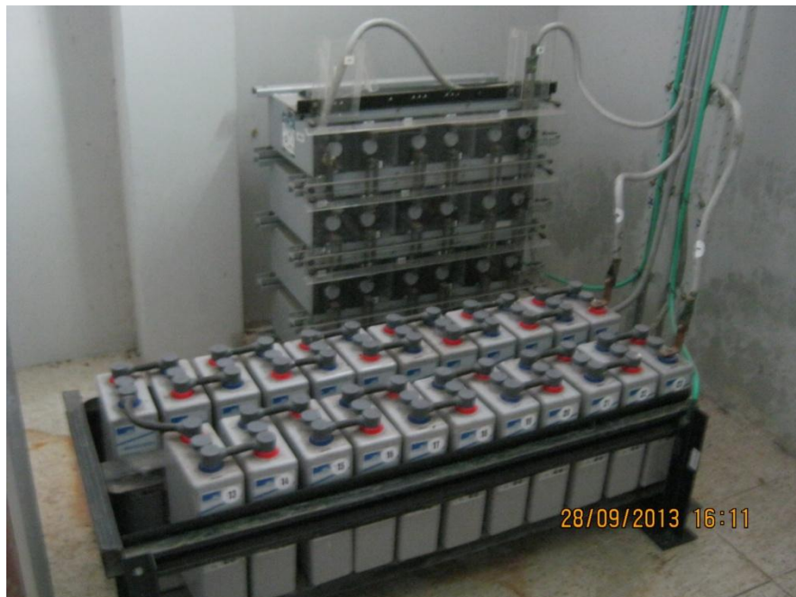
Figura 3.8 Cuarto Batería Central Lago Capeira
