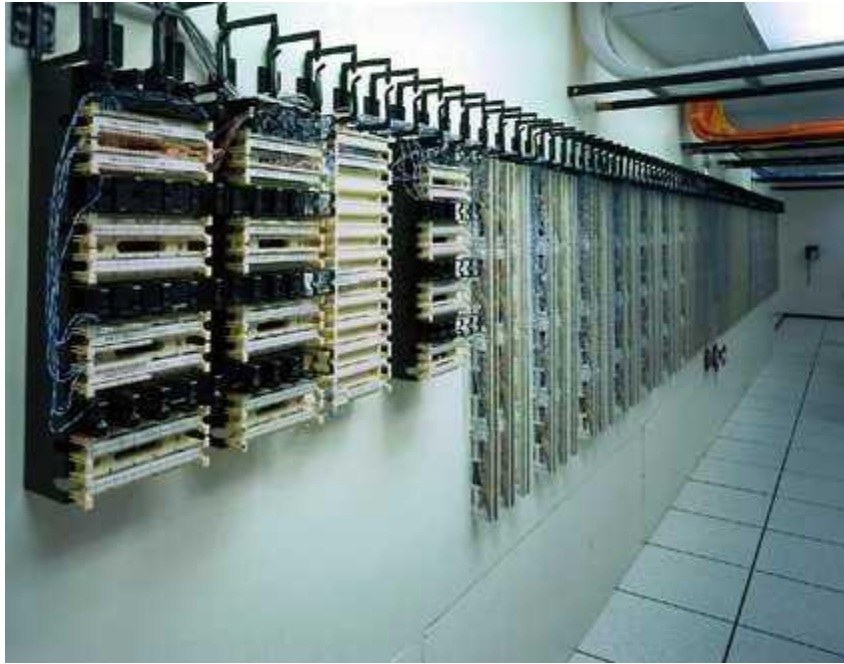
Figura 2.6 Marco de Distribución Principal
