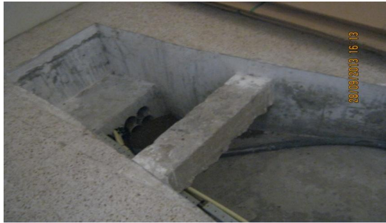
Figura 3.5 Cable 1200 Pares del Cuarto Botella de Central Lago Capeira [15]
