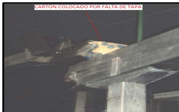
Fig. 13 Deterioro de estructura transporte de tapas
