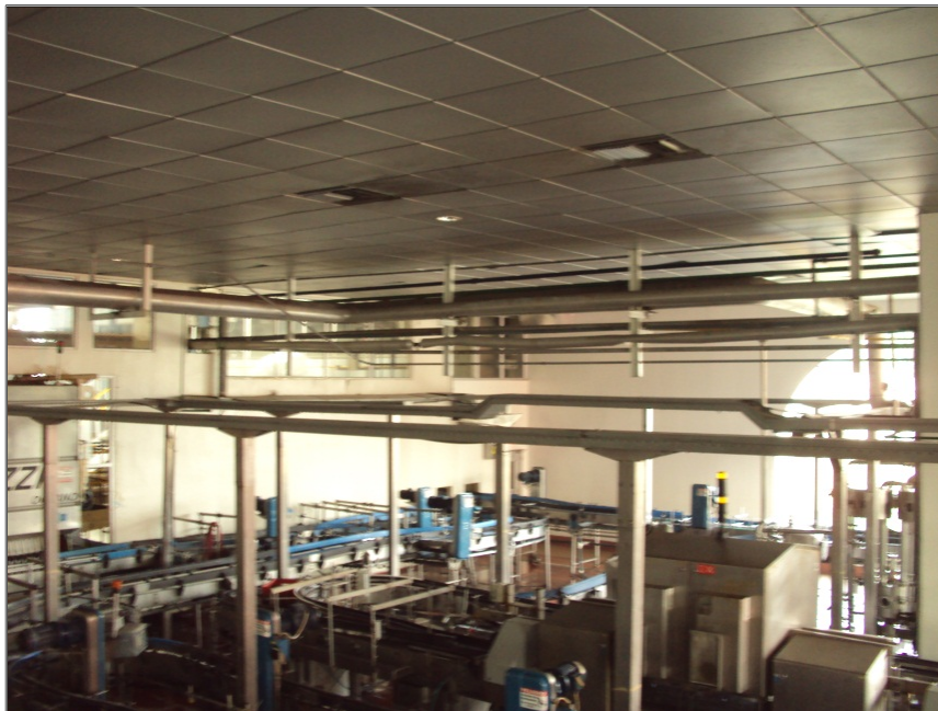
Fig. 2 Zona de inspección y llenado de envase de línea 5
