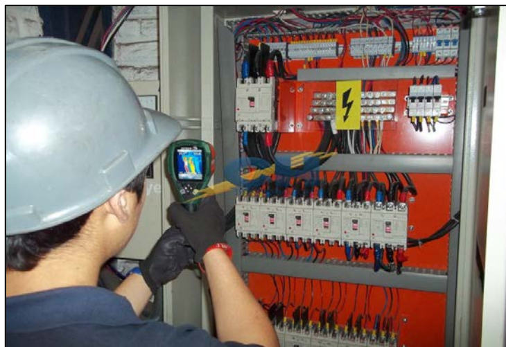
Fig. 23 Análisis termografico de panel eléctrico
