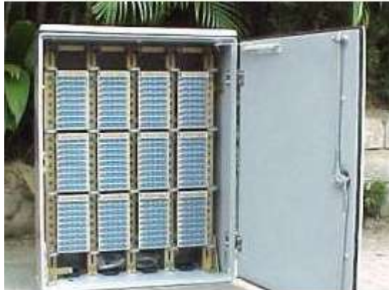
Figura 4.15: Armario de distribución [23]
