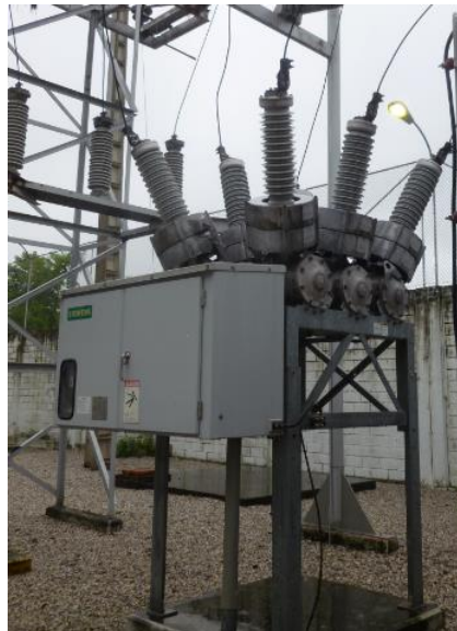
Figura 1.6 Interruptor en Gas SF6
