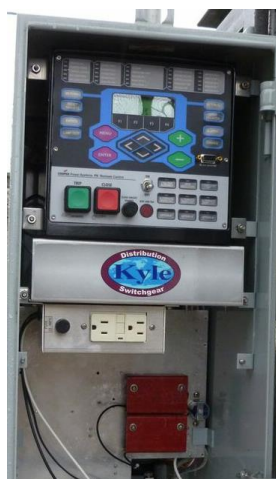
Figura 1.11 Vista interna del controlador Cooper forma 6.
