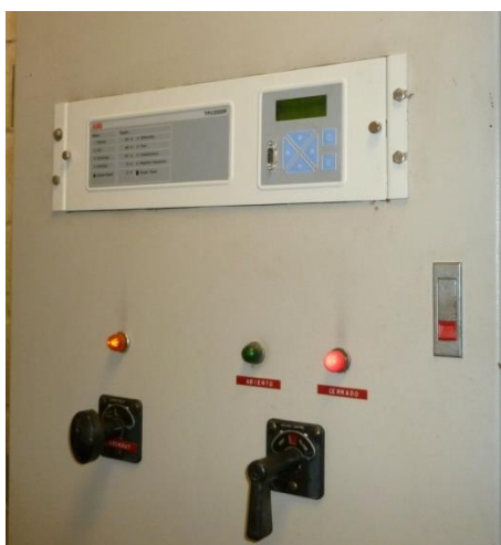
Figura 1.17 Panel de Control con el relé TPU2000R en la parte superior.
