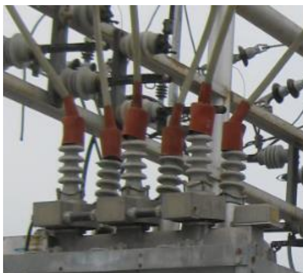
Figura 1.13 Transformadores de corriente en la S/E Cerro Blanco.
