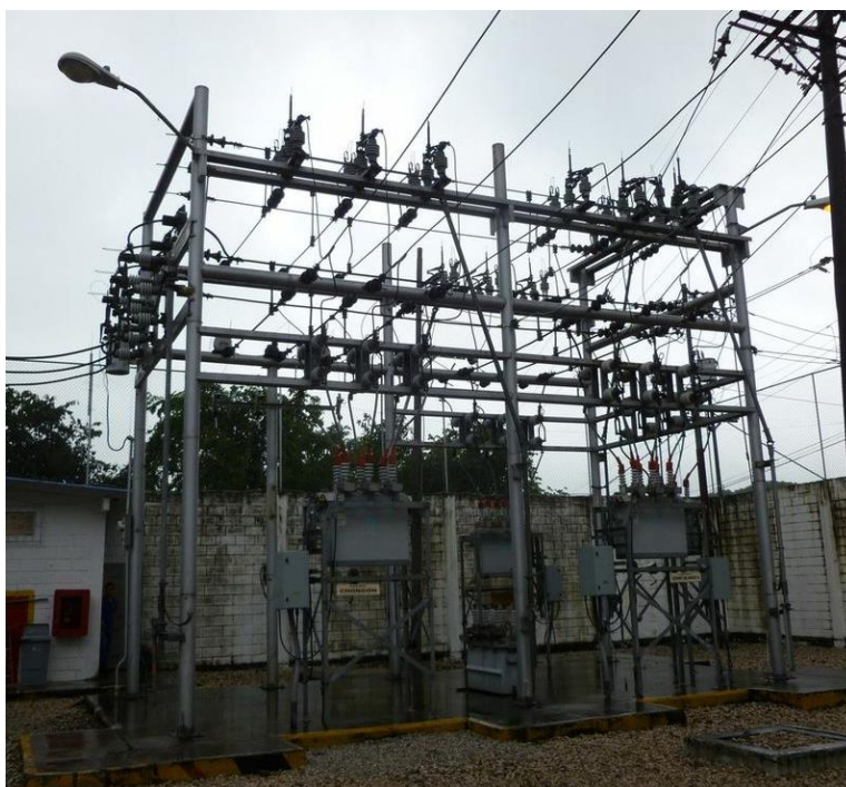
Figura 1.10 Patio de 13.8 KV.
