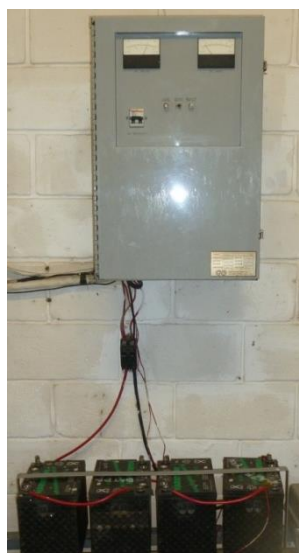
Figura 1.14 Cargador GNB y baterías marca Marathon
