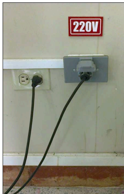
Figura 2.11. Instalación Eléctrica Adicional de 220[V]_{AC}
