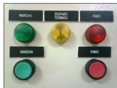
Figura 1.15. Vista de las Luces Piloto y Pulsadores
