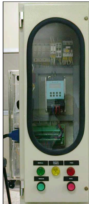
Figura 1.12. Vista Frontal del Panel Eléctrico
