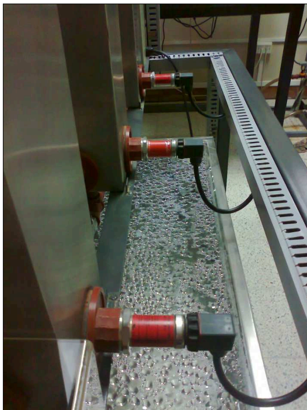
Vista de los Sensores de Presión
