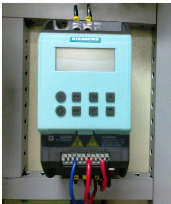
Vista del Variador de Frecuencia
