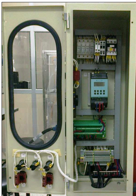
Vista del Panel Eléctrico
