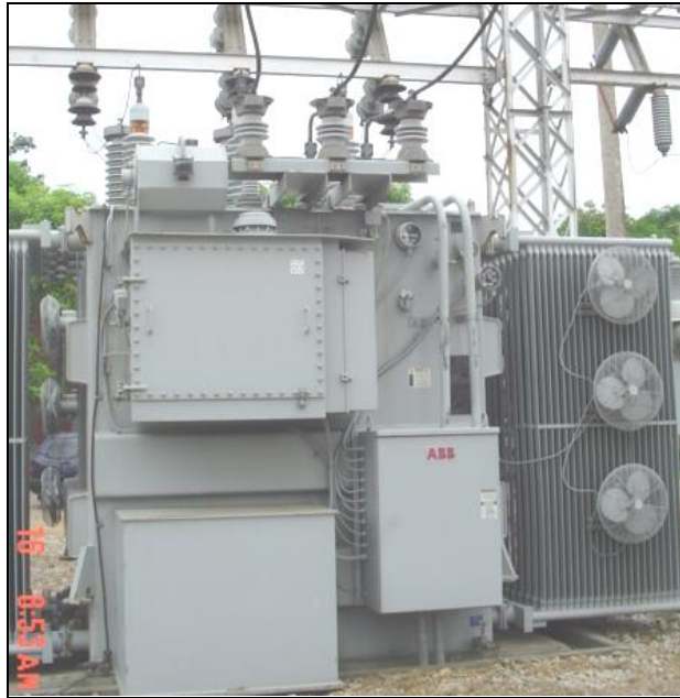
Fig. Pararrayos sobre Transformador en lado de Baja Tensión
