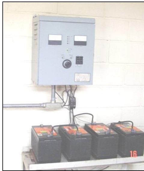
Fig. Banco de baterías en cuarto de control
