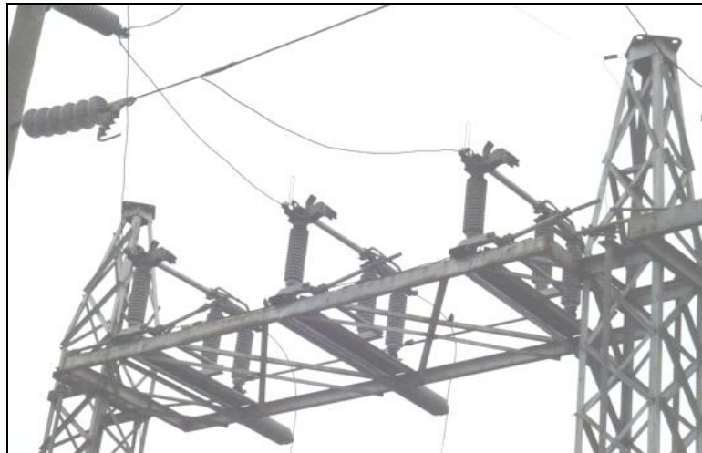
Figura 4.3 Seccionador de aire con cuchillas de tierra
