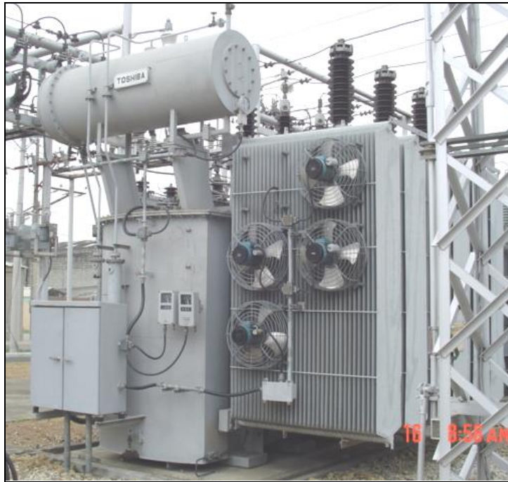
Fig. 4.6 Transformador de poder marca TOSHIBA 67/13.8Y KV
