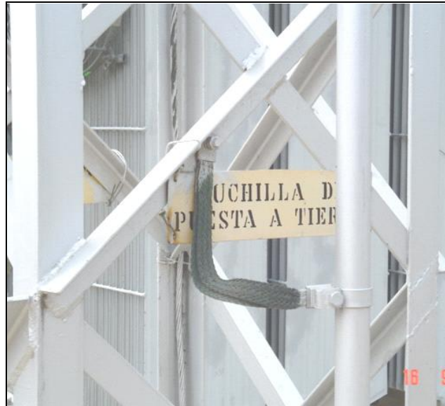
Fig. Puesta a Tierra de Estructuras de la Subestación
