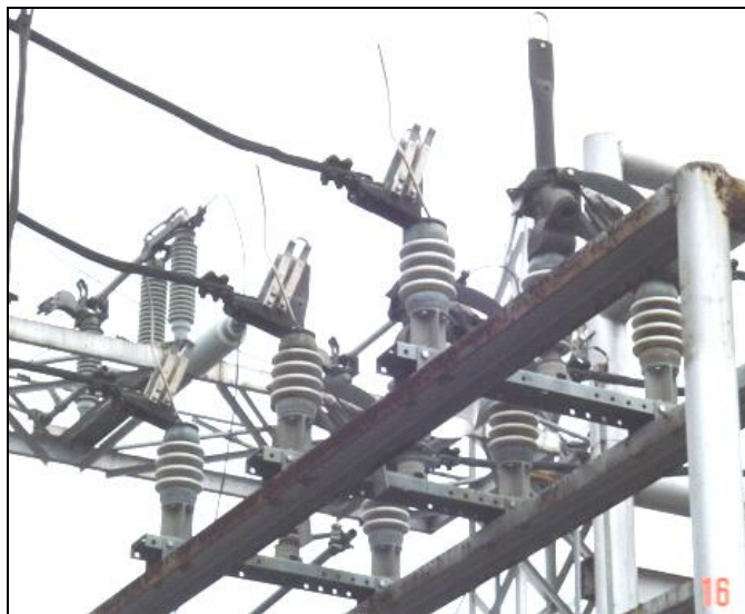
Fig. 4.13 Seccionador de Interconexión entre Barras
