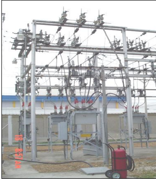
Fig.4.7 Patio de 13.8 KV
