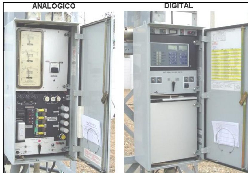
Fig. 4.10 Gabinetes de control de los Reconfiguradores
