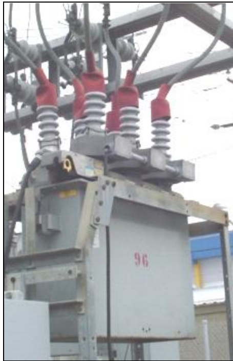
Fig. 4.9 Reconectador de alimentadora
