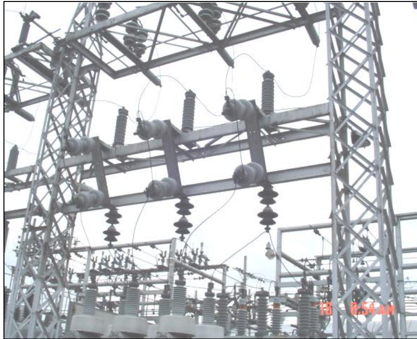
Fig. 4.2 Aisladores y Herrajes en patio de 69 KV
