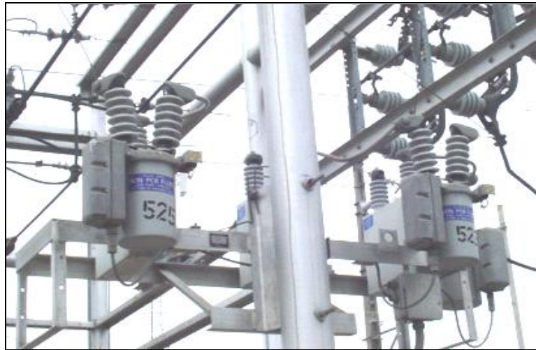
Fig. Banco de Capacitores desconectables
