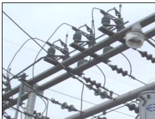
Fig. 4.12 Seccionadores de Interconexión entre Alimentadoras
