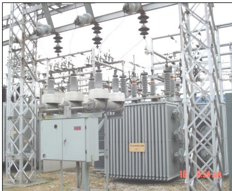
Fig. 4.1 Patio de Subestación de 69 KV
