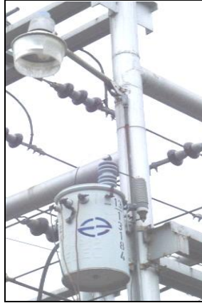
Fig. Transformador de Distribución para Servicios Auxiliares
