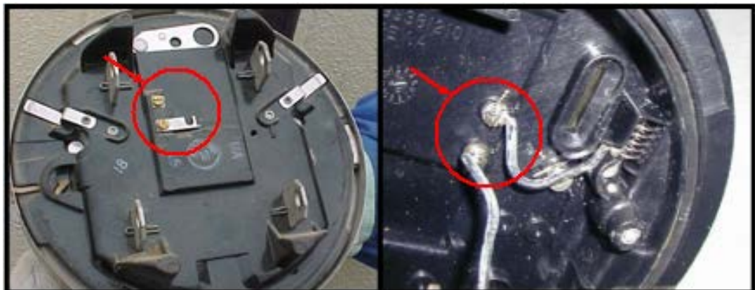
FIGURA 12. DESCONEXION DE LA BOBINA DE POTENCIAL.
