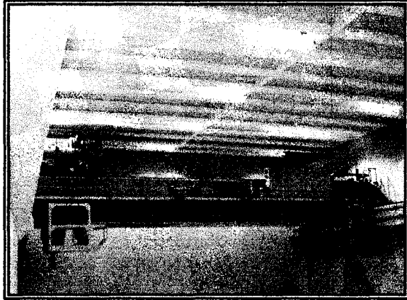
Fig. 1.12: Grúa Principal de la Casa de Máquinas
