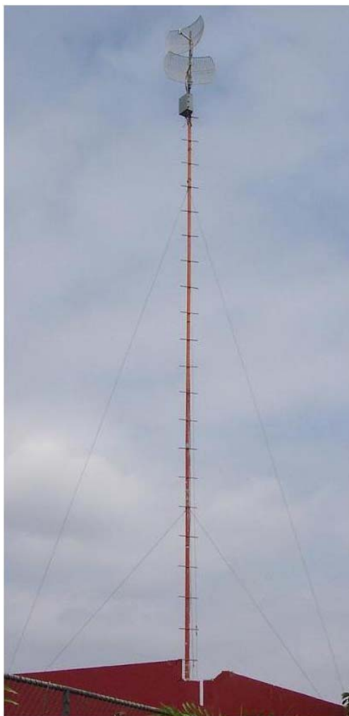
Fig. 2.10 Torre de transmisión.
