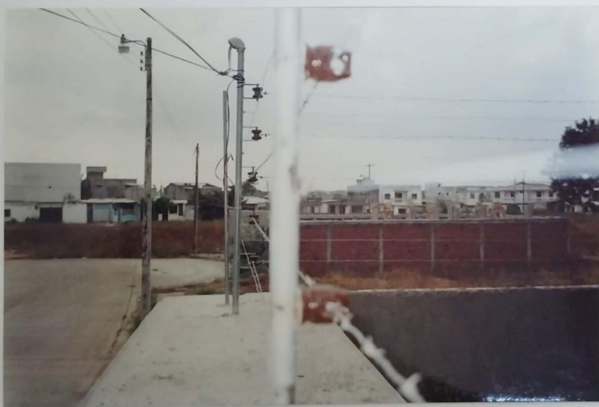
FIGURA 35.- AISLADORES TRIPA DE PATO DE CERAMICA EN LOS SOPORTES INTERMEDIOS
