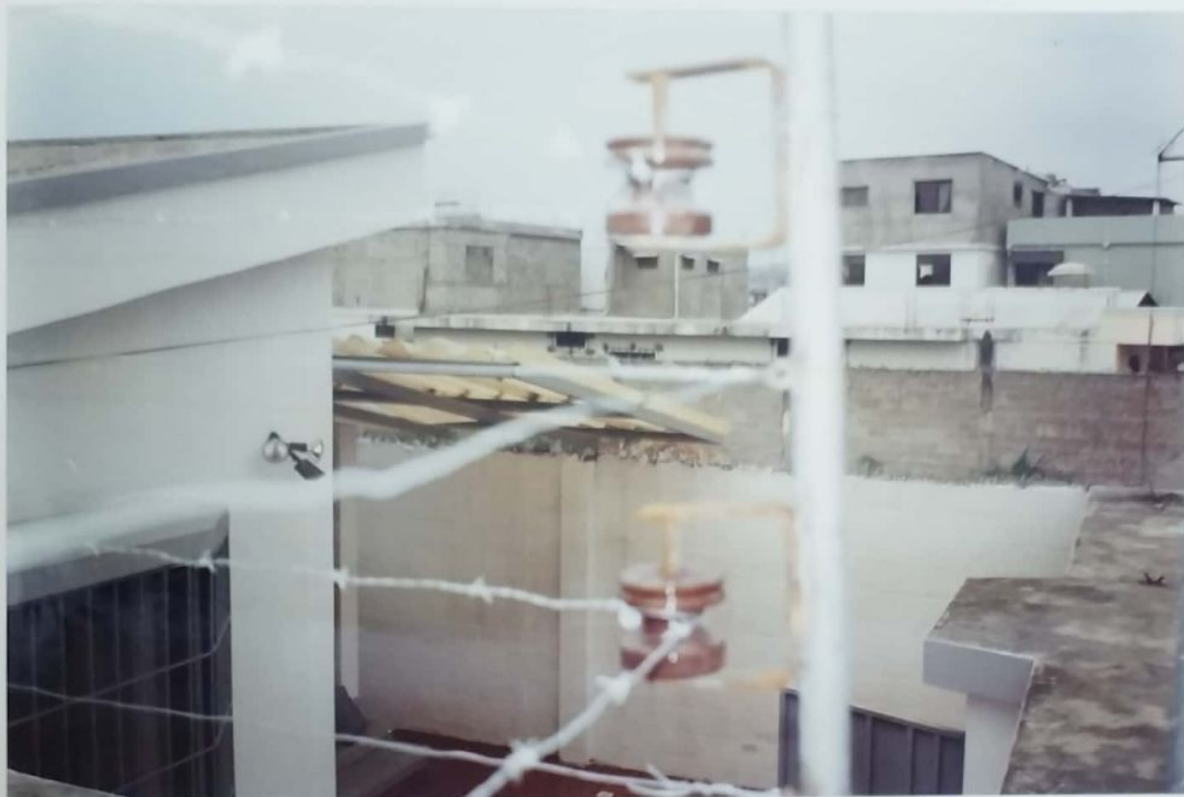
FIGURA 34.- AISLADORES CILINDRICOS COLOCADOS EN LOS SOPORTES ESQUINEROS
