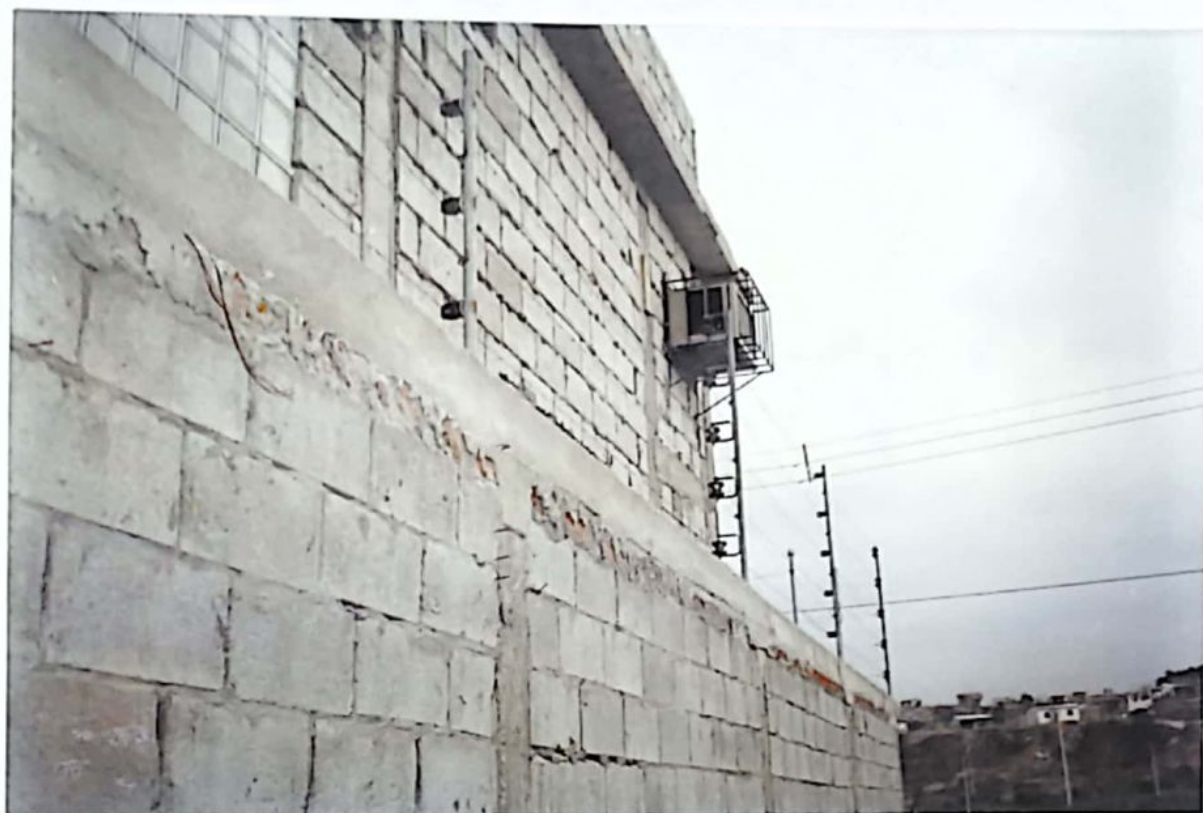
FIGURA 39.- VISTA LATERAL DE LA MALLA ELECTRIFICADA
